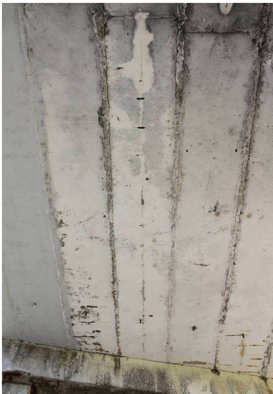
Obr. 41 Fotka – 219 - trhliny prebiehajúce rovnobežne s pozdĺžnou osou konštrukcie
