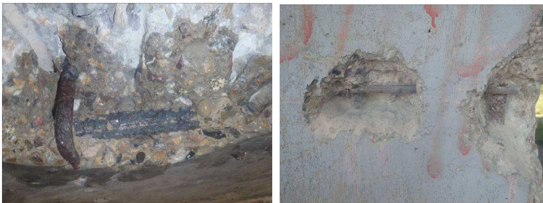
Obr. 11 Odkrytie betonárskej výstuže
