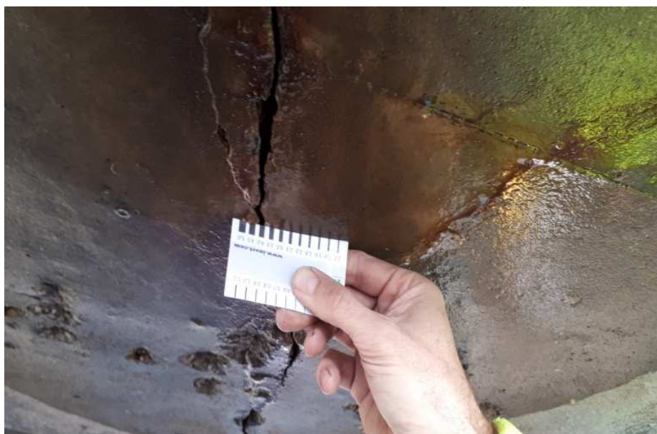
Obr. 46 - priečna trhlinka cez nosníky – šírka 4,0 mm
