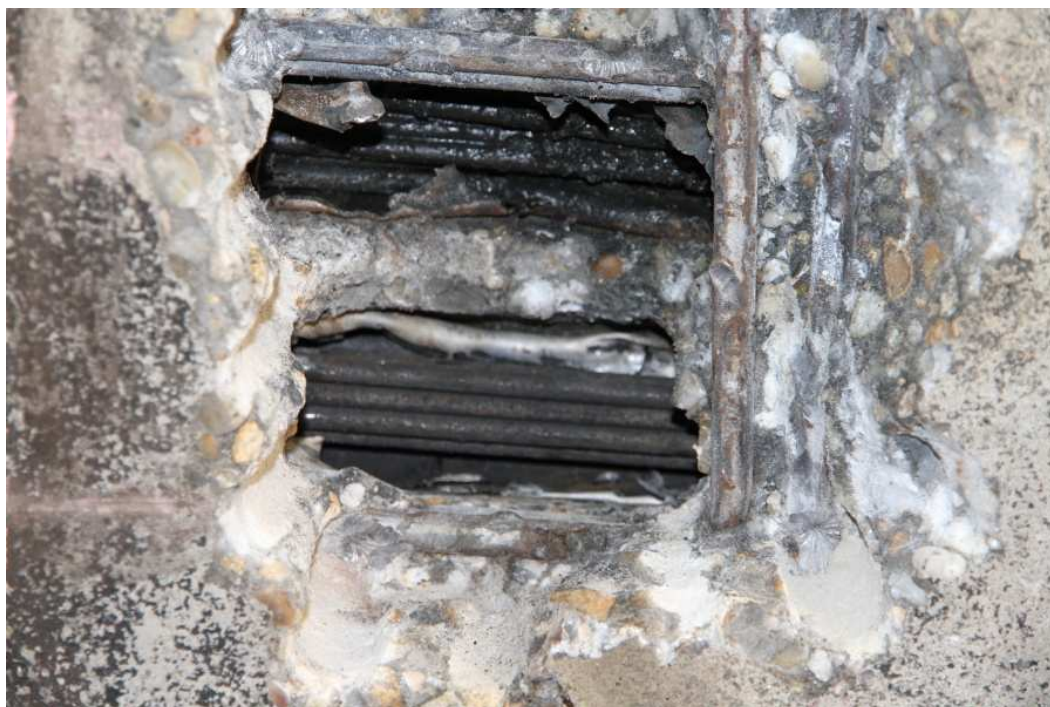
Obr. 16 Odkrytie kanálikov K3 – skorodované drôty, bez injektáže
