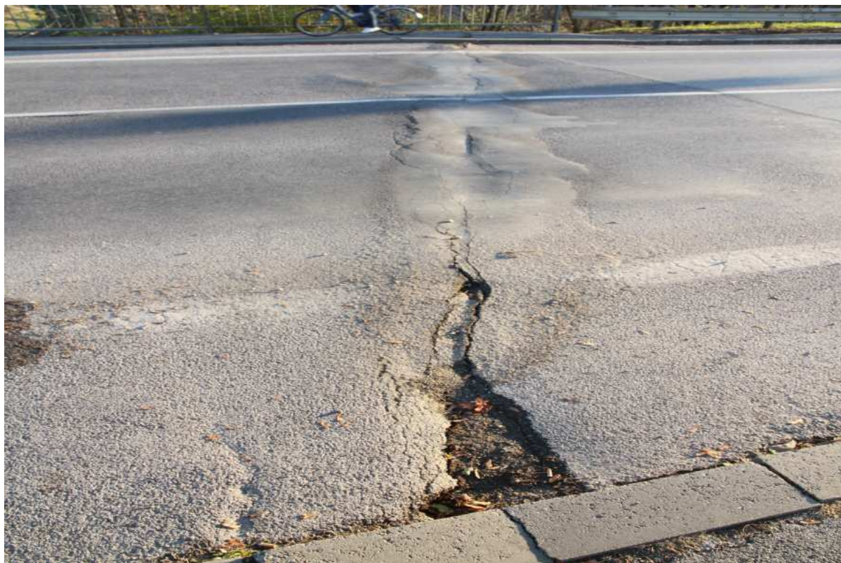
Obr. 32 - Prekopírovaná dilatácia na povrch vozovky, nerovnosti
