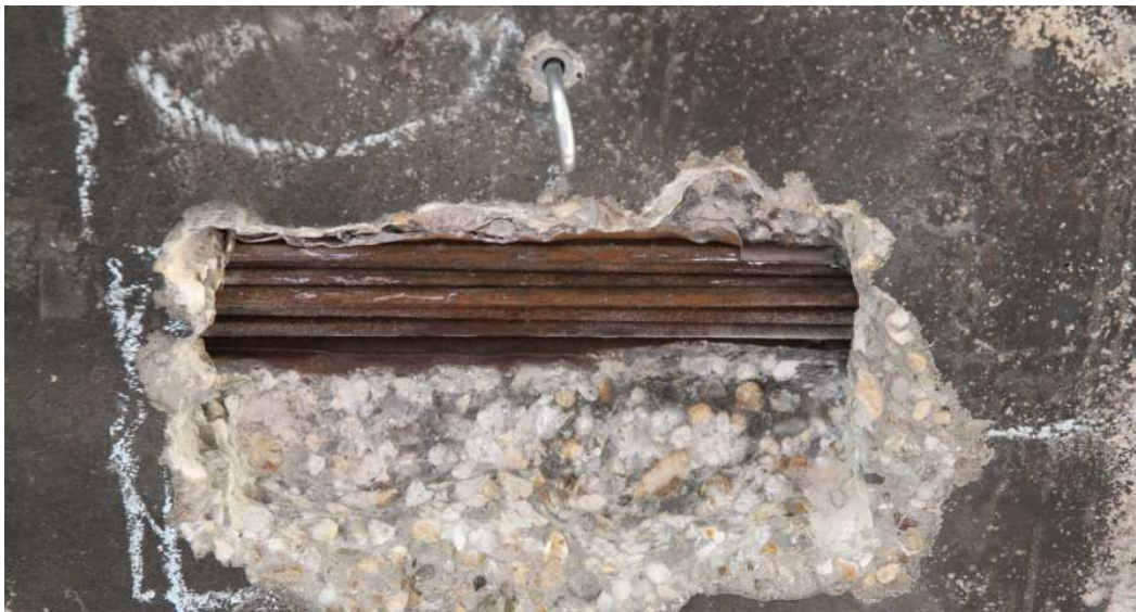
Obr. 14 Odkrytie kanálika K1 – skorodované drôty, bez injektáže
