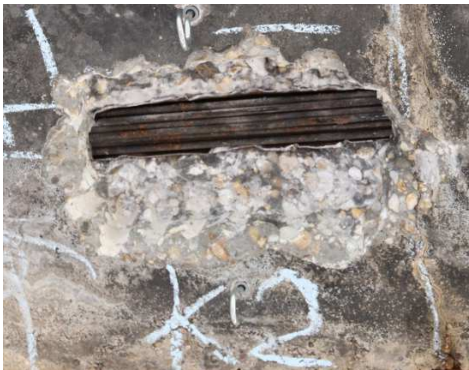
Obr. 15 Odkrytie kanálika K2 – skorodované drôty, bez injektáže
