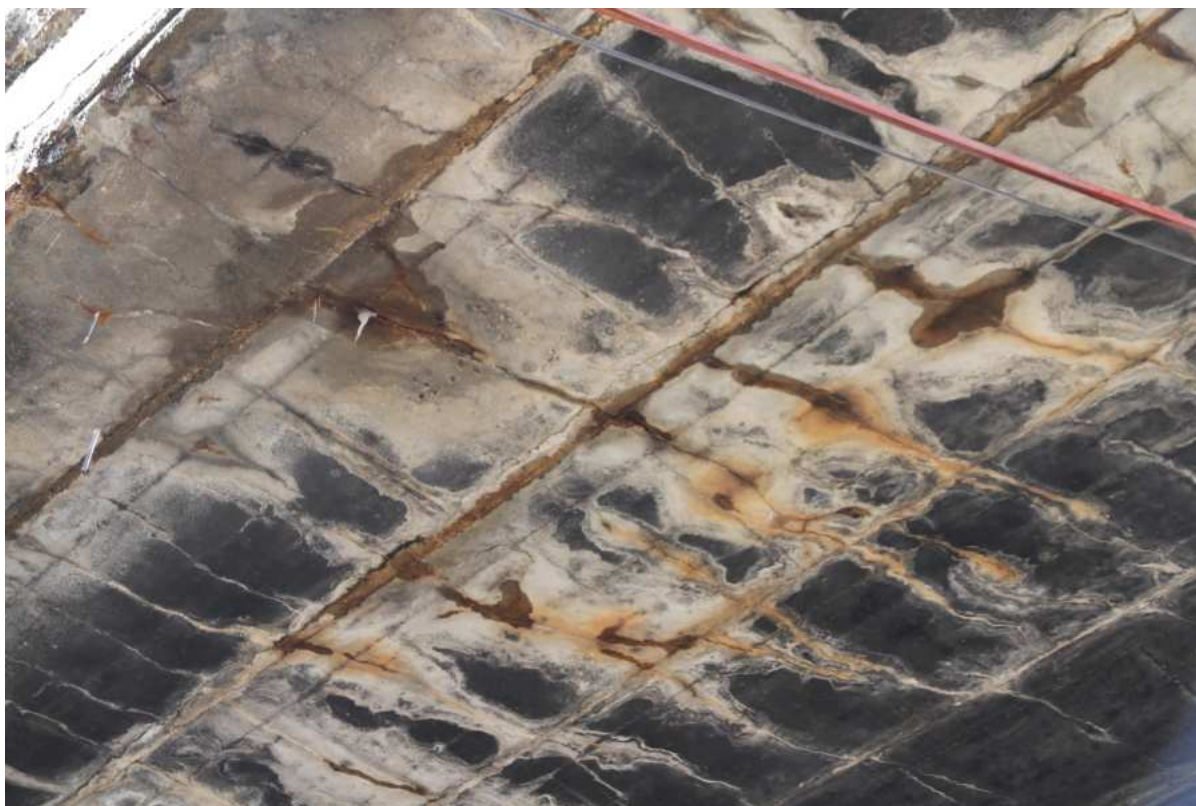
Obr. 25 - Nosníky – priečne trhliny, zatekanie
