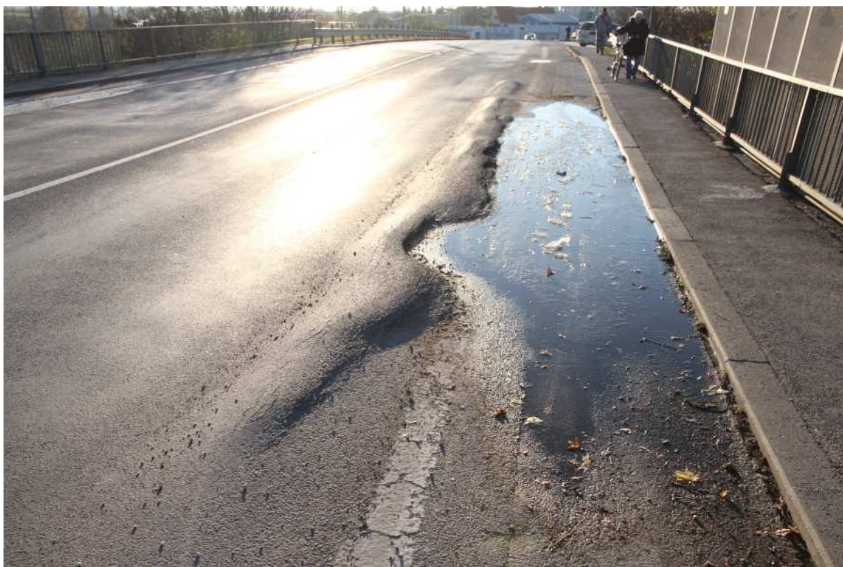
Obr. 30 - Deformácie vozovky na moste
