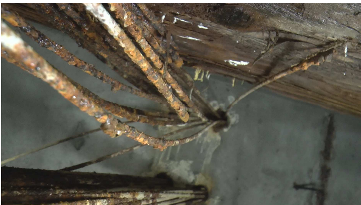
Obr. 18 Stav priečného predpätia v komore – hĺbková korózia, väčšina drôtov úplne prekorodovaných
