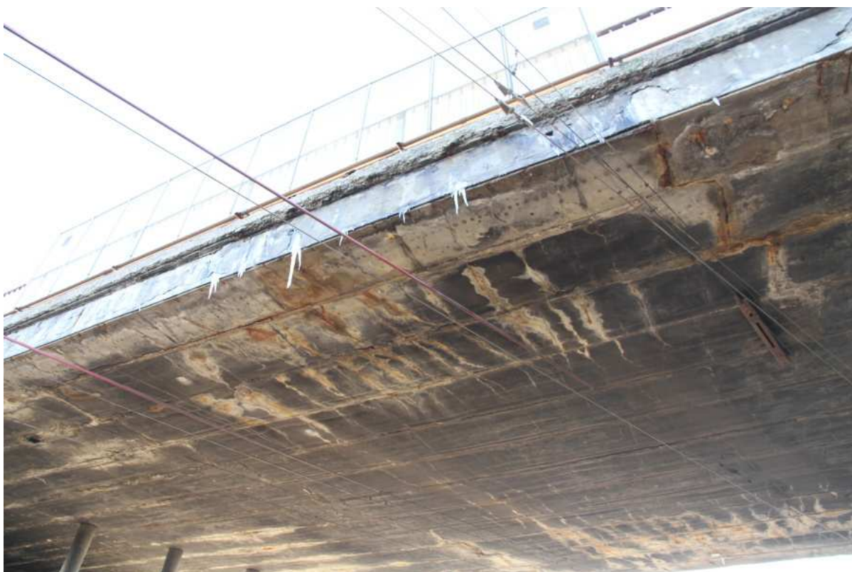
Obr. 26 - Nosníky – priečne trhliny, otvorené škáry, zatekanie
