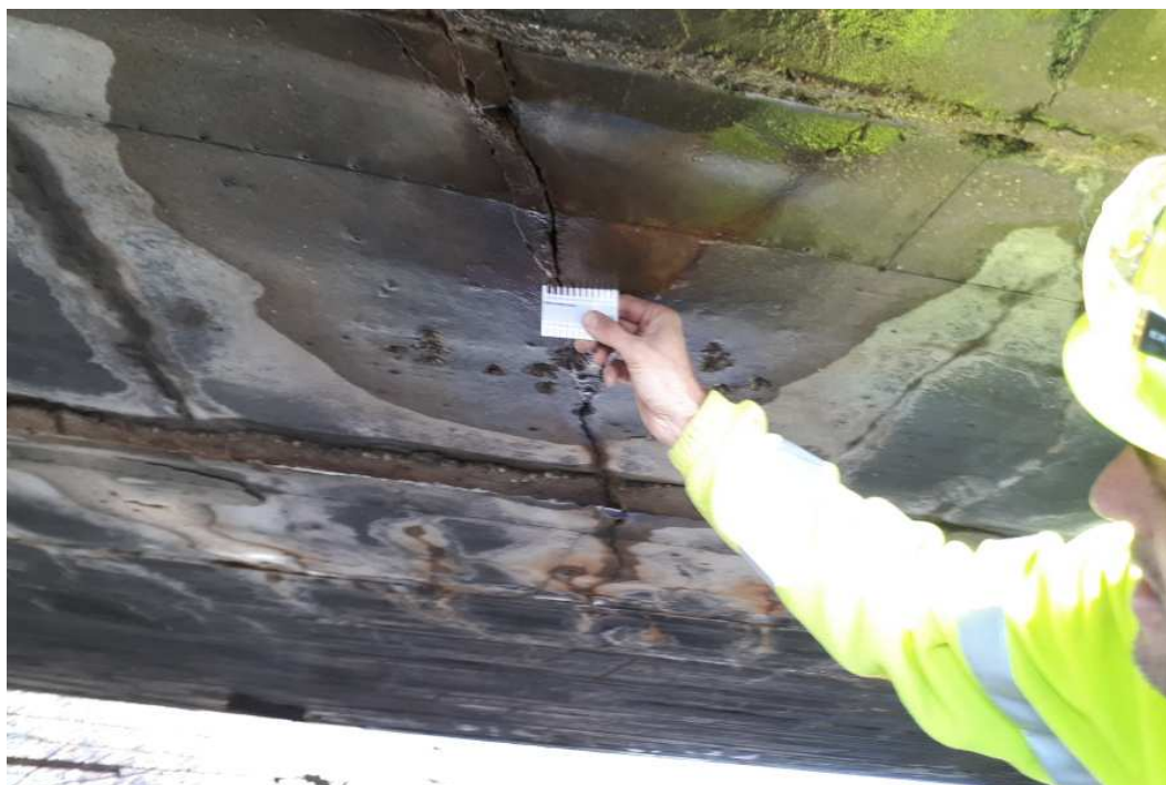
Obr. 45 - priečna trhlinka cez nosníky
