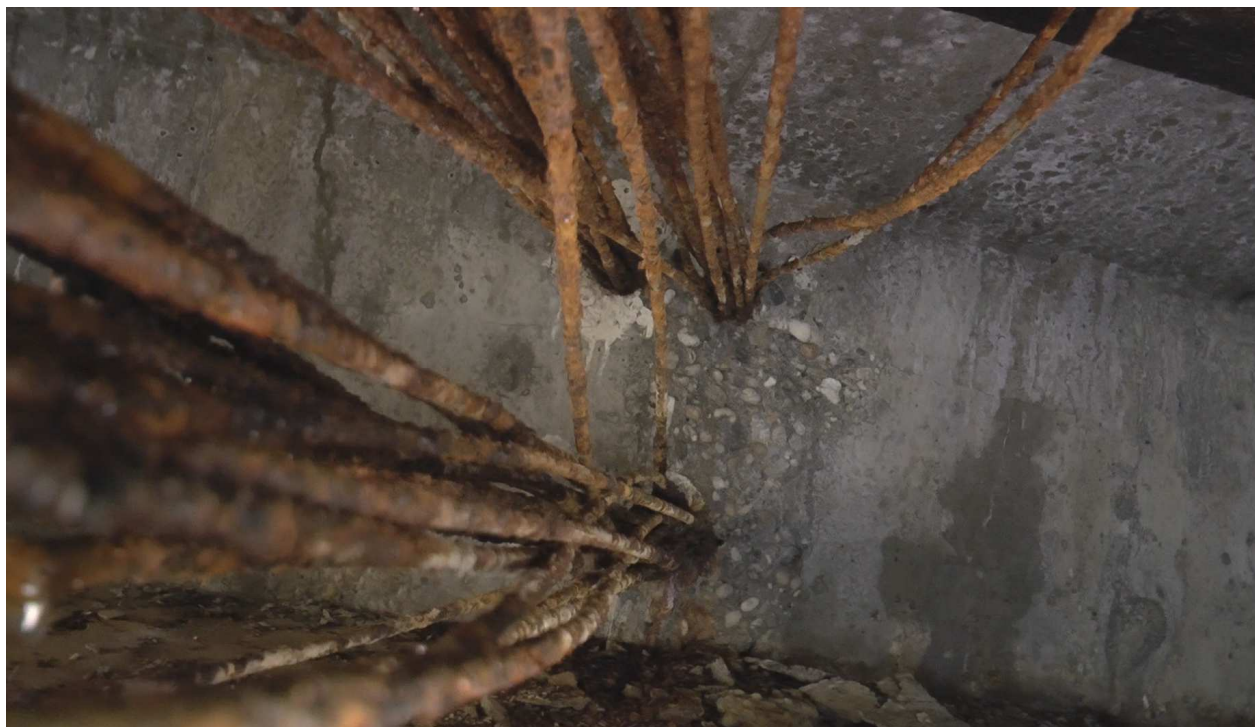
Obr. 19 Stav priečneho predpätia v komore – hĺbková korózia, väčšina drôtov úplne prekorodovaných
