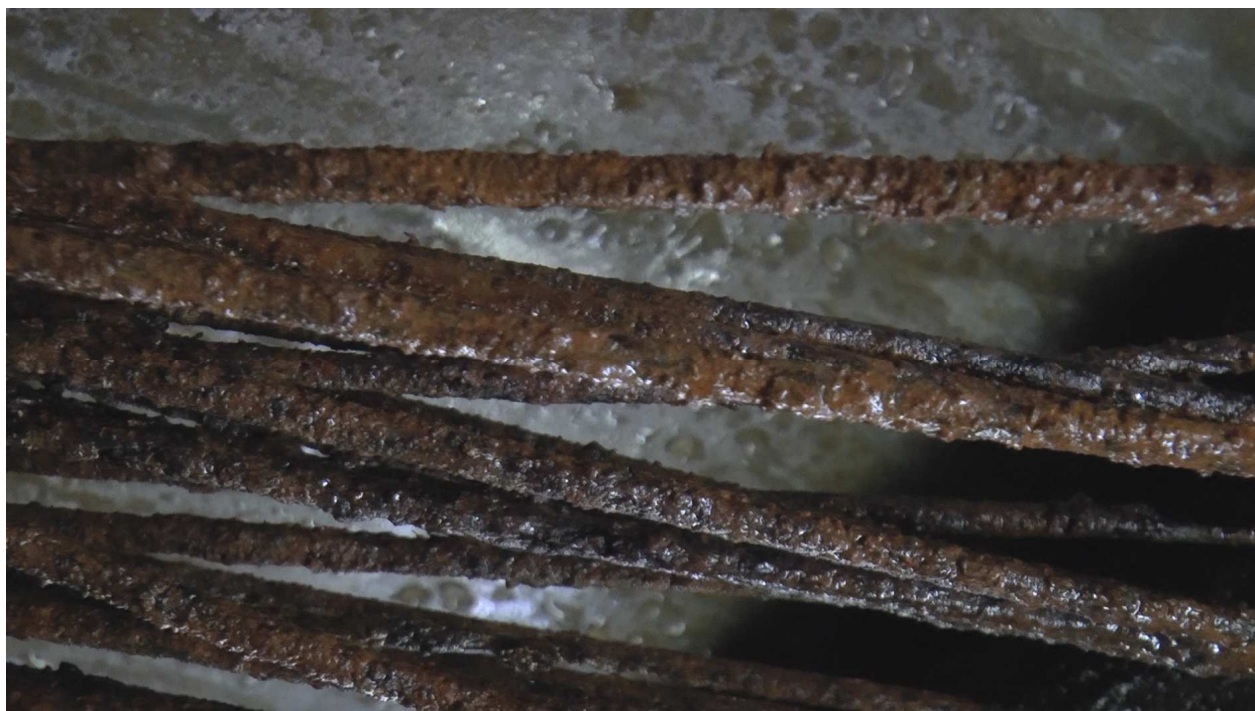
Obr. 20 Stav priečneho predpätia v komore – detail stavu jednotlivých drôtov
