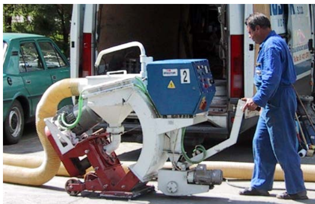
Celkový pohľad na otryskávacie zariadenie
