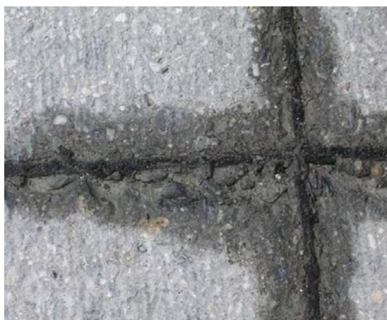
Porušenie na priečnej a pozdĺžnej škáre spôsobené frézou na šírku a hĺbku 40 až 50 mm
