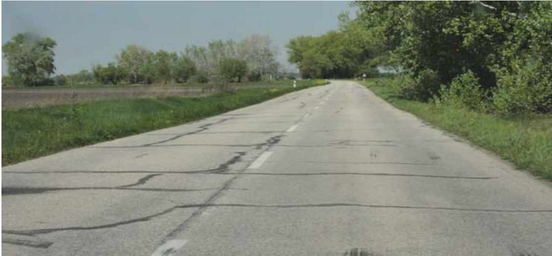
Klasifikačný stupeň 4 – nevyhovujúci
