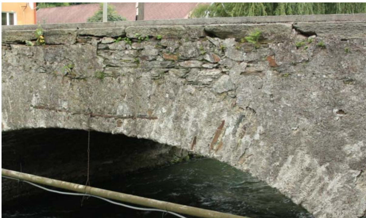
Porušenie ochrannej omietky muriva
