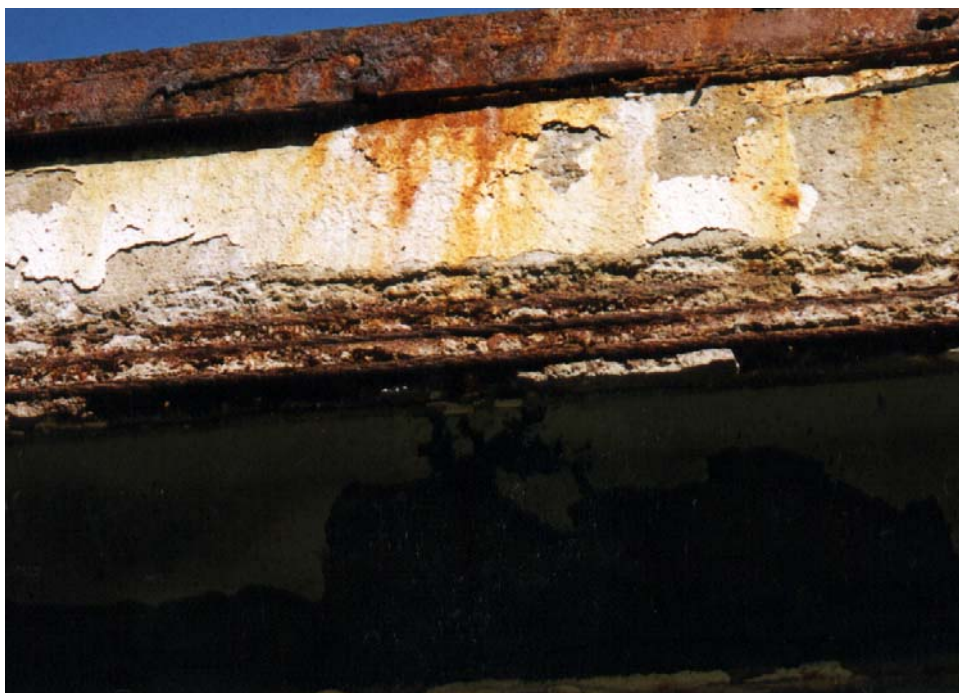
Obnažená vopred predpätá výstuž
