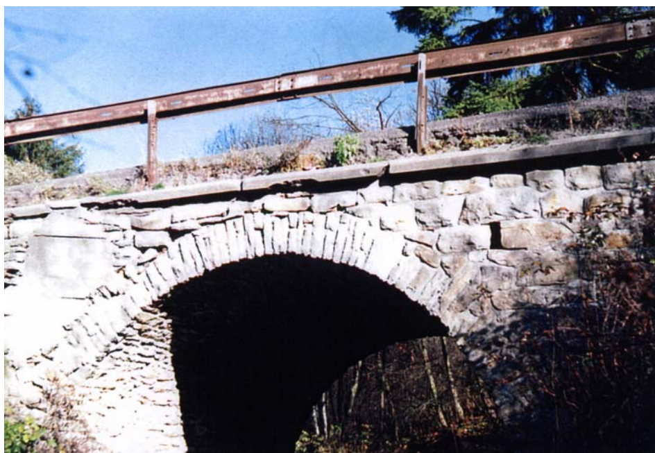
Vypadávanie malty v murovanej kamennej klenbe
