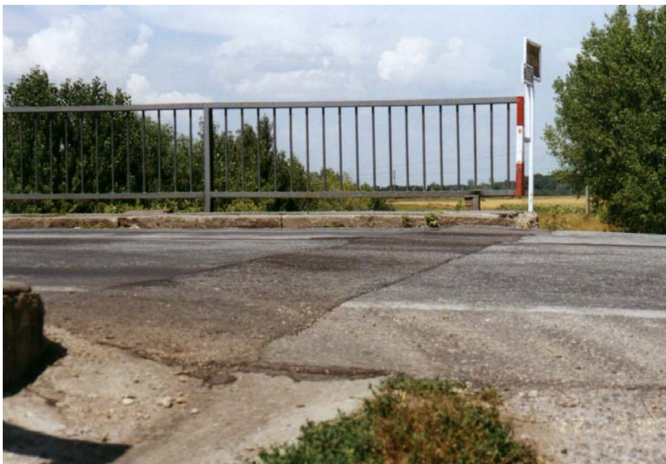
Poklesnutie vozovky s čiastočným odstránením poruchy
