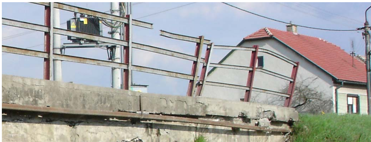
Zábradlie poškodené nárazom
