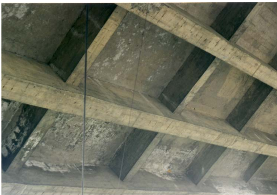
Výkvety na ŽB konstrukci
