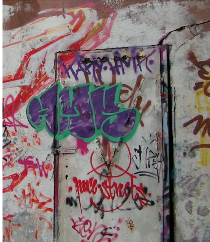
Poškodenie vstupu do mostného objektu - vandalizmus
