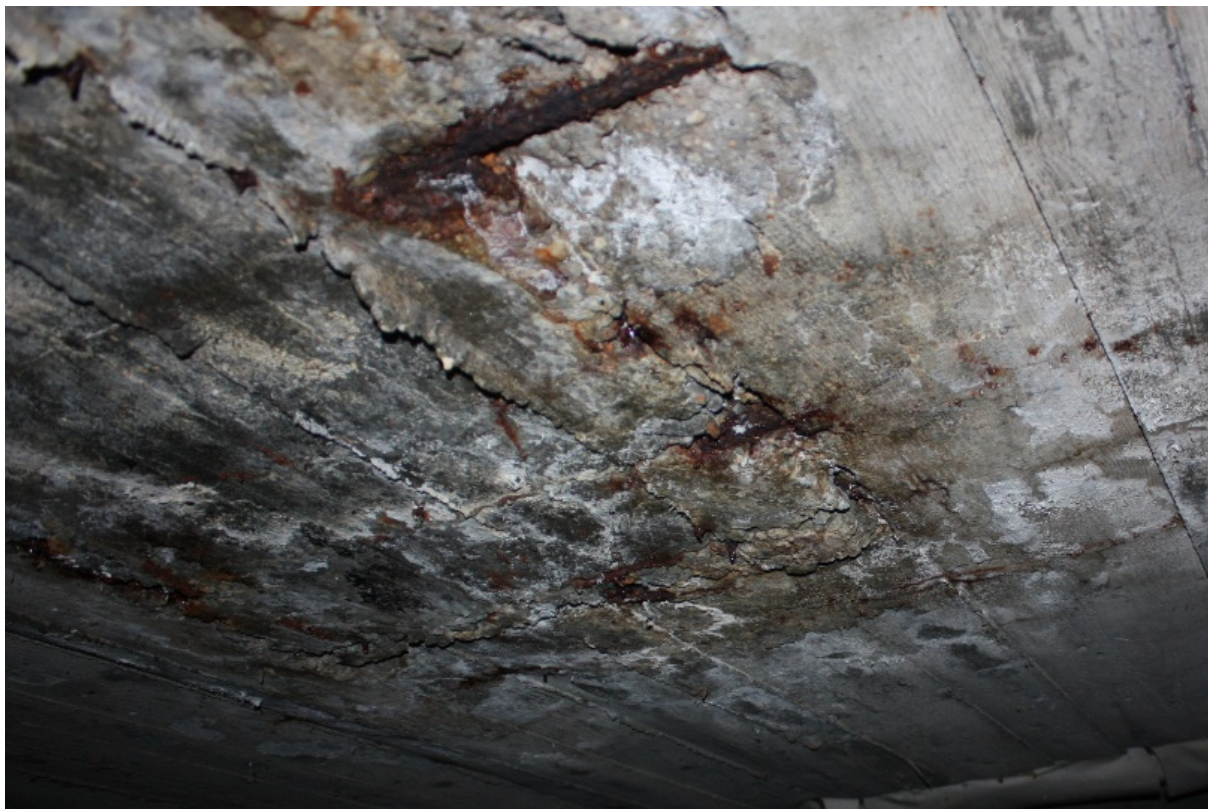
Zle zabetónovaný montážny otvor s výraznými následkami (zatekanie, korózia nosnej výstuže mostovky, odlupovanie betónu, trhliny).
