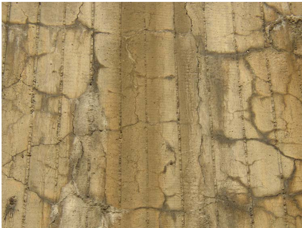
Povrchové sieťové trhlinky
