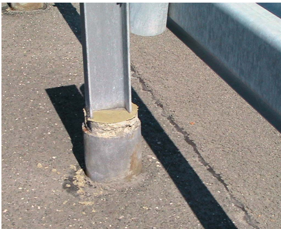
Poškodené kotvenie stĺpika zvodidla
