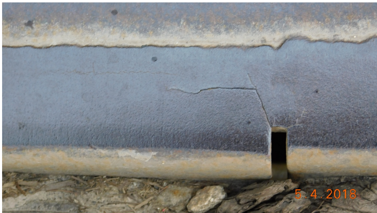
Trhliny v základnom materiáli
