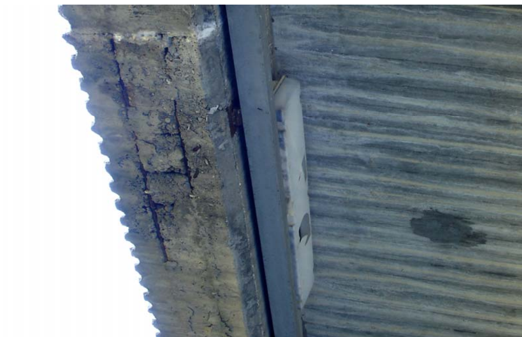
Poškodené osvetľovacie teleso
