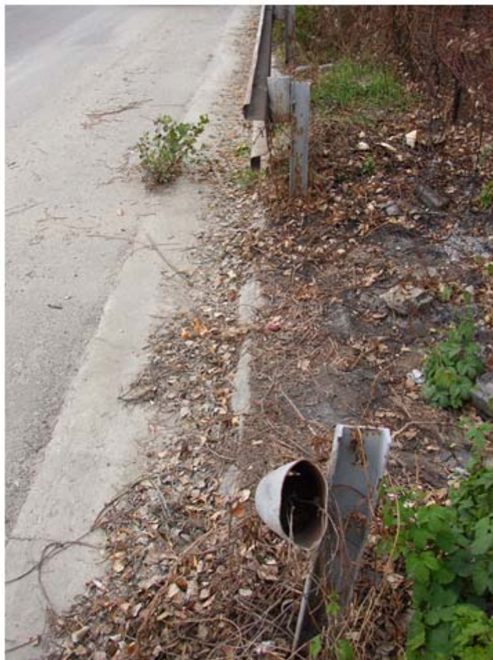
Chýbajúca zvodnica zvodidla
