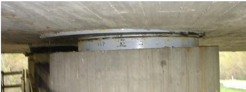
Nesprávne nastavenie ložiska
