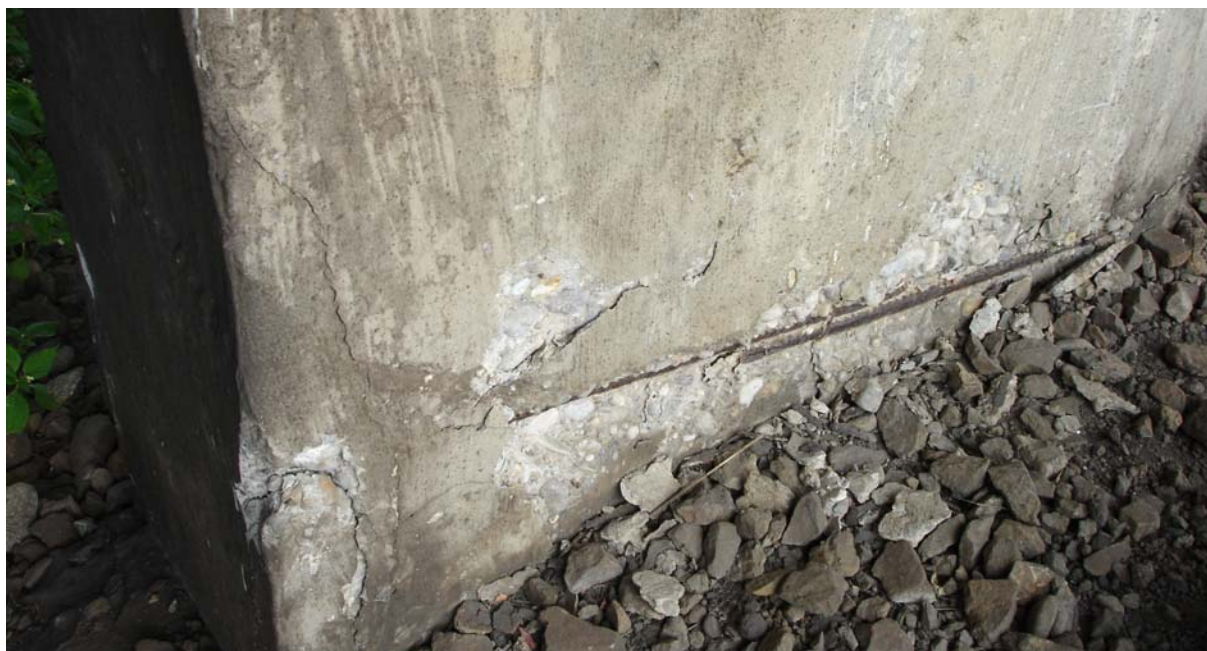
Lokálne napúčanie a odlamovanie betónu
