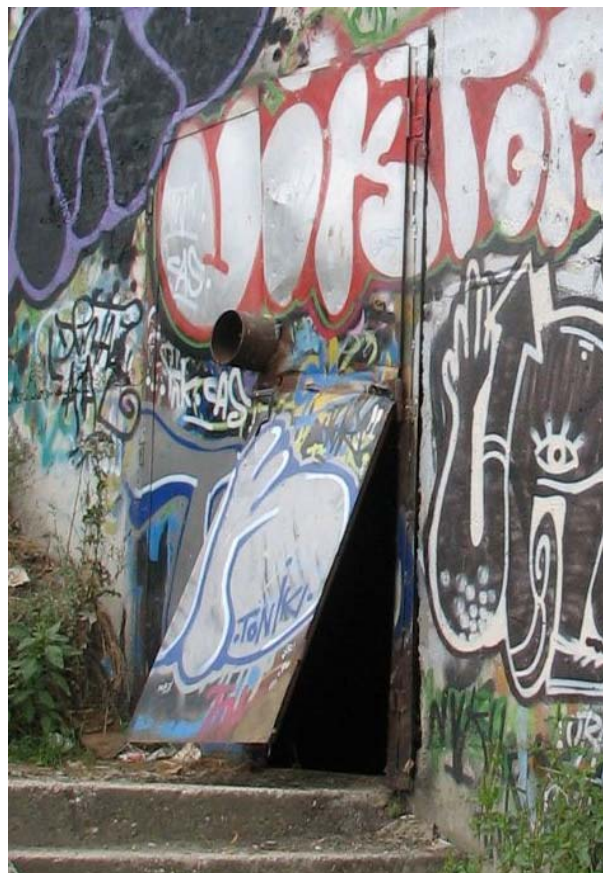
Poškodenie vstupu – mechanické poškodenie
