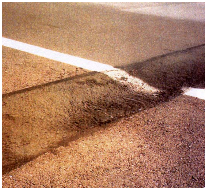
Vytiahnutie spojiva z asfaltového mostného záveru
