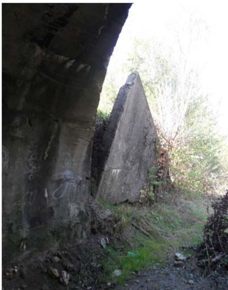
Podomletie krídla z dôvodu chýbajúcej prídlažby a dláždených zvodov.
