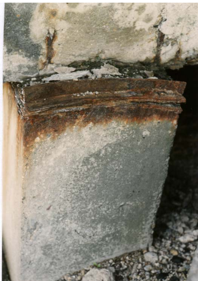
Korozívne rozpínanie plechov ložiska
