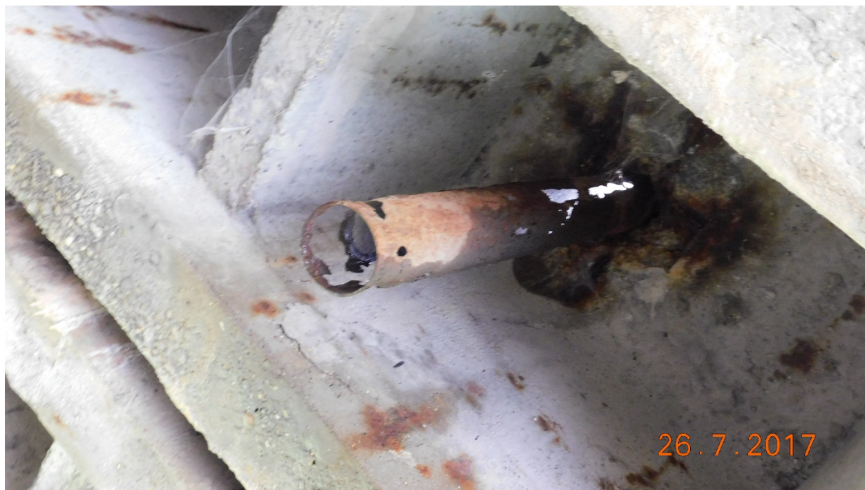
Porušenie odvodňovacieho potrubia koróziou
