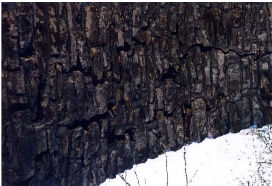
Prasklina v kamennej murovanej klenbe
