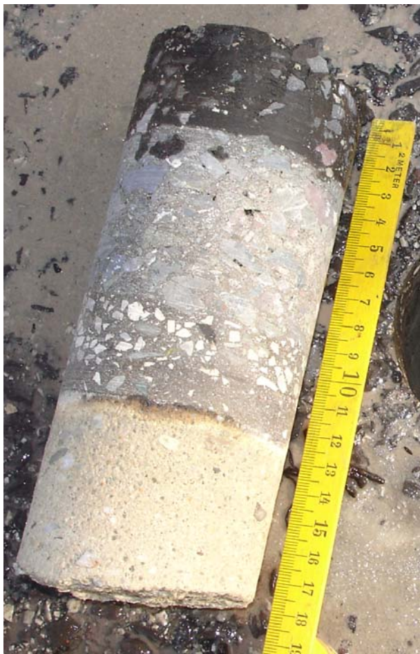
Nadmerná hrúbka vozovky
