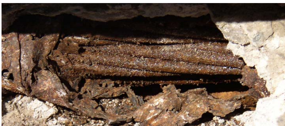
Silná korózia predpínacej výstuže
