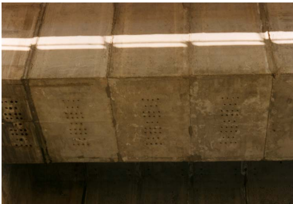
Nedostatočne vyplnené lepené škáry medzi segmentami, čiastočne opravené
