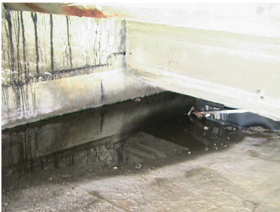
Stojatá voda v uložení v priamom styku s konštrukciou ložiska
