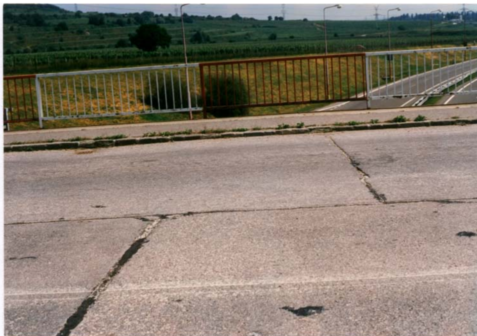
Blokové trhliny vo vozovke
