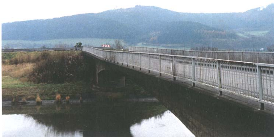
Mostná konštrukcia s trvalým priehybom
