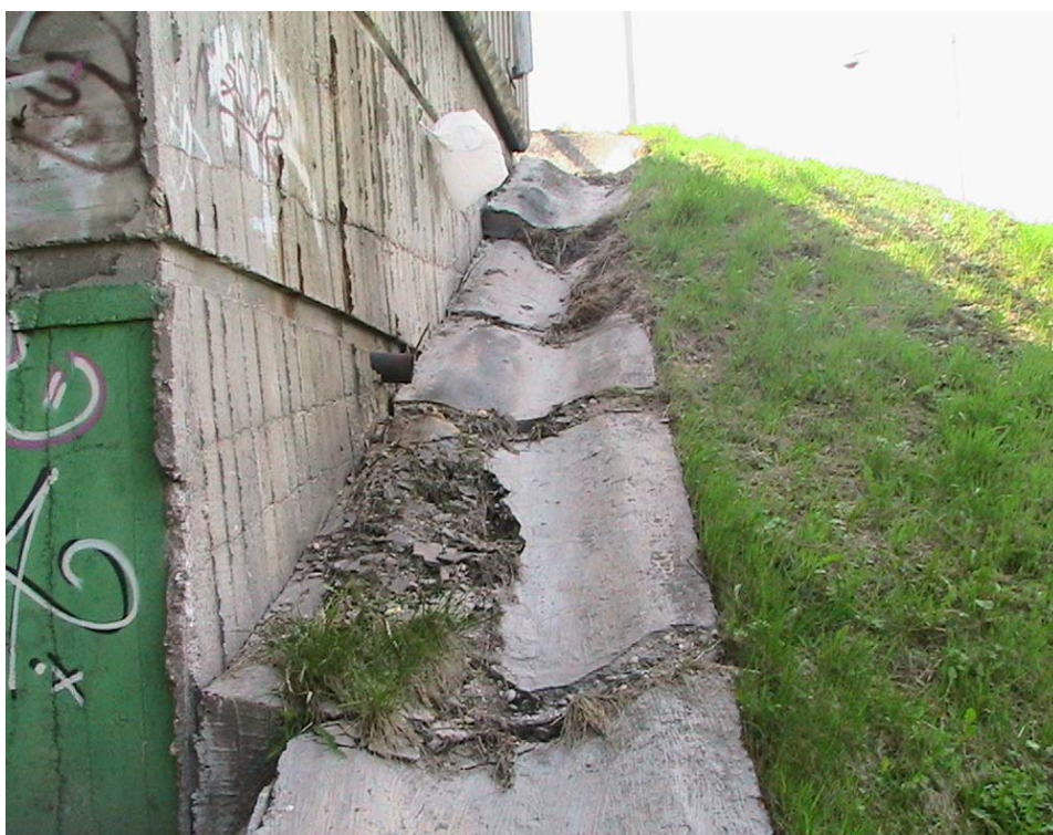
Poškozený odvodňovací rigol
