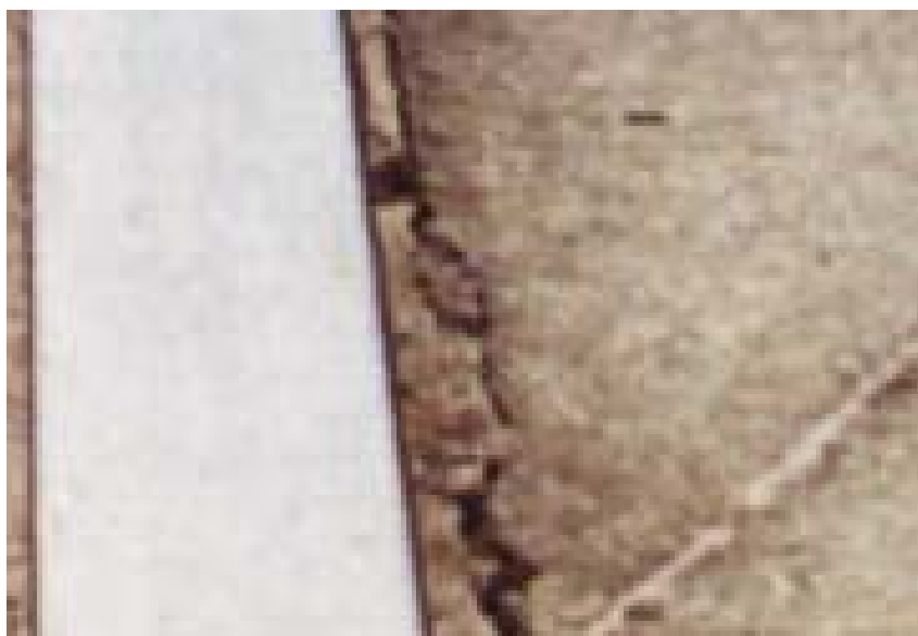
Poškodená zálievka škáry
