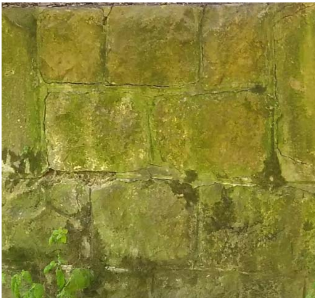
Trhliny medzi murovacími prvkami
