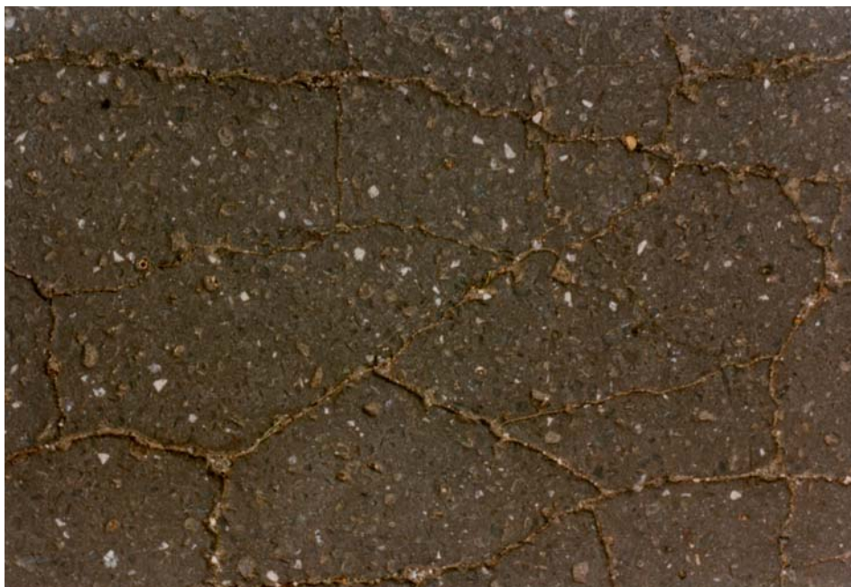
Sieťové trhliny vo vozovke
