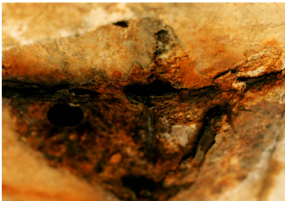
Úplne skorodovaná, rozpadnutá betonárska výstuž
