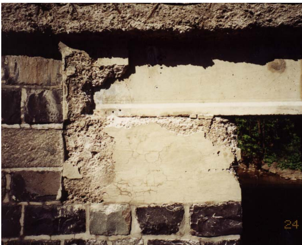
Zablokovanie nosníka v dilatačnej škáre
