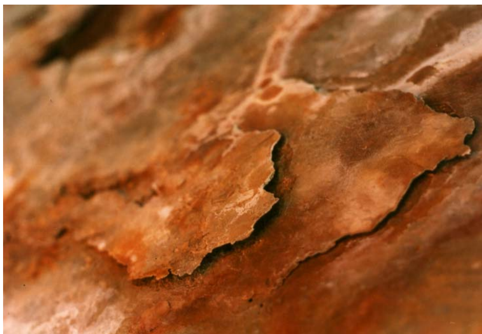
Odlamovanie betónu účinkom korozívneho rozpínania výstuže
