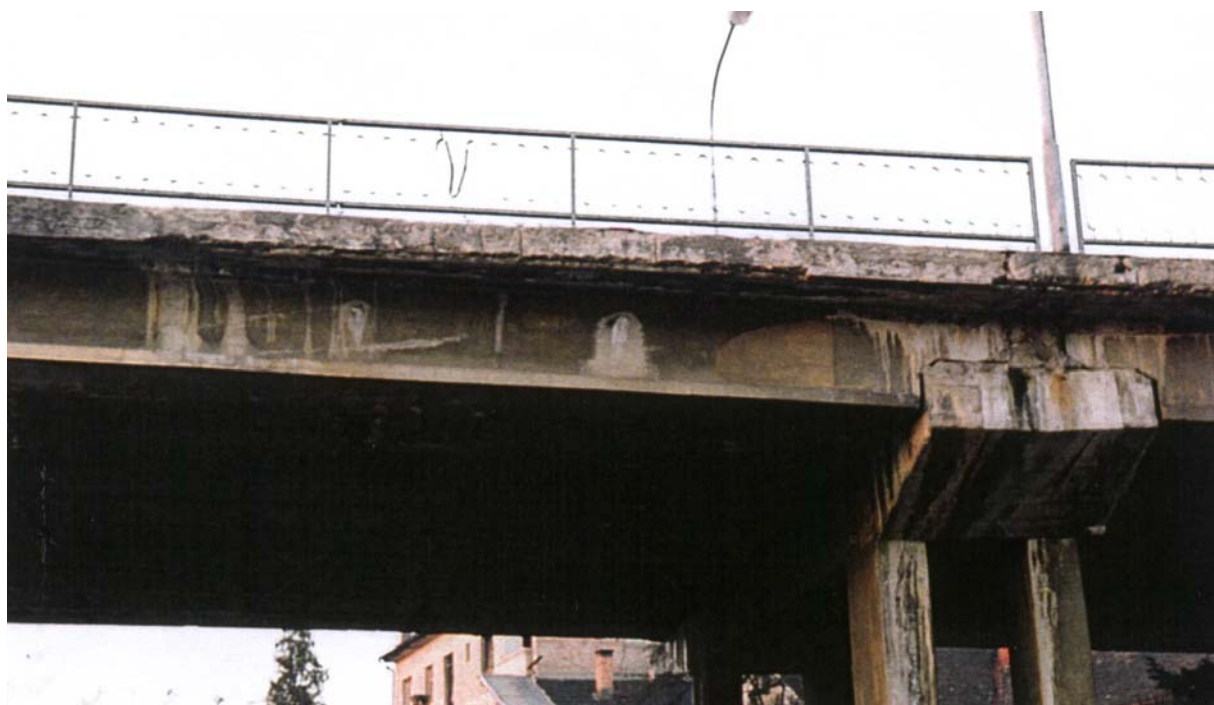
Trhliny, kopírujúce dráhu predpínacích káblov
