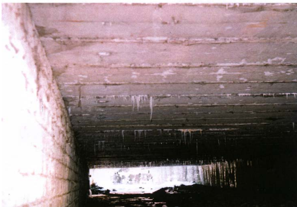
Poškodená hydroizolácia v miestach stykov nosníkov
