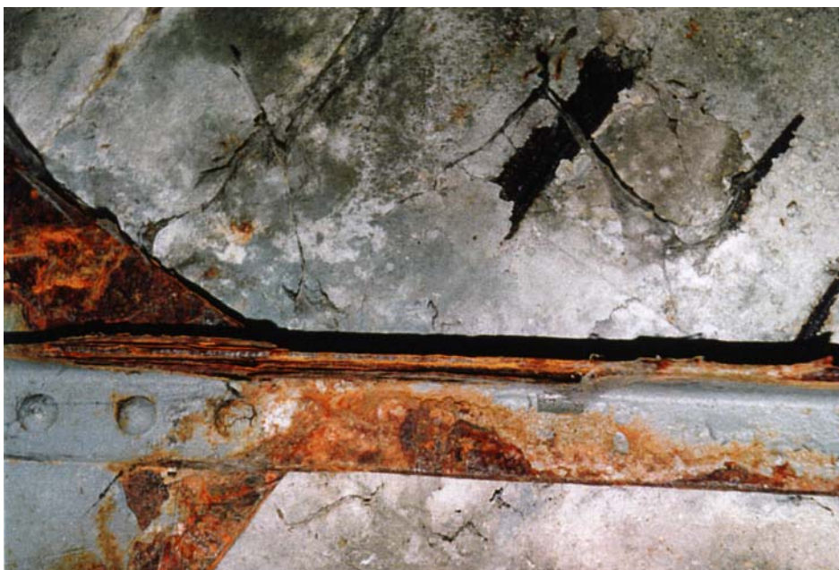
Korozívne zväčšovanie ocele v styku prvkov konštrukcie
