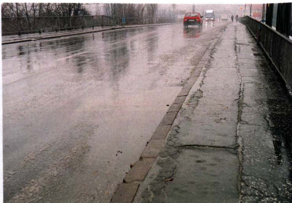
Neodtekajúca voda na vozovke mosta
