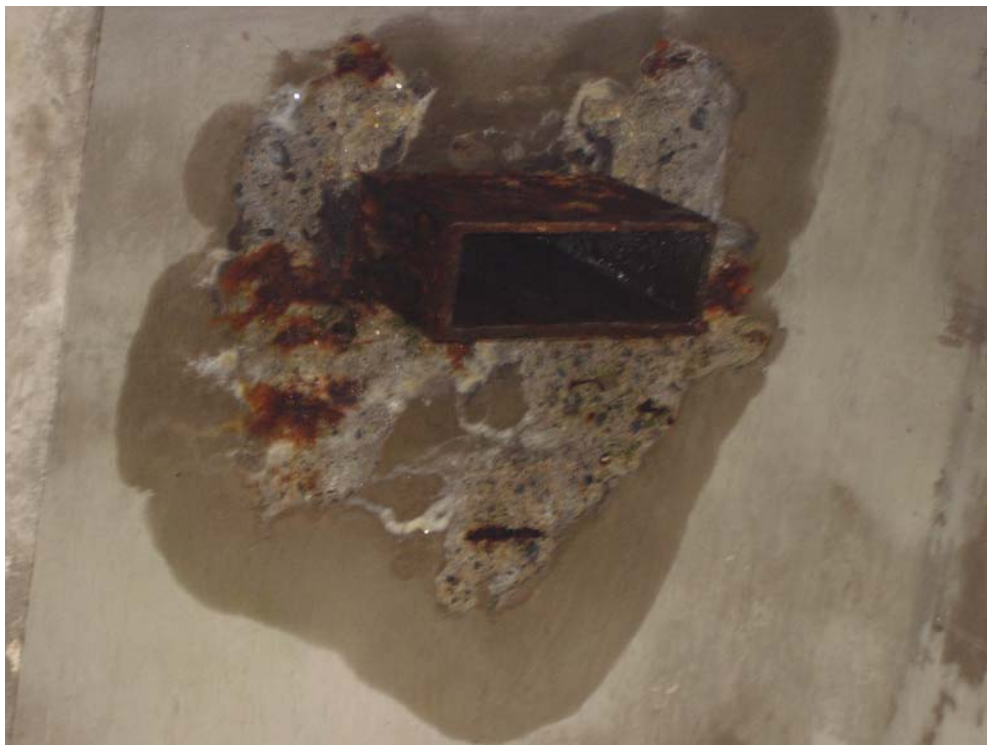
Zatekanie vedľa odvodňovača
