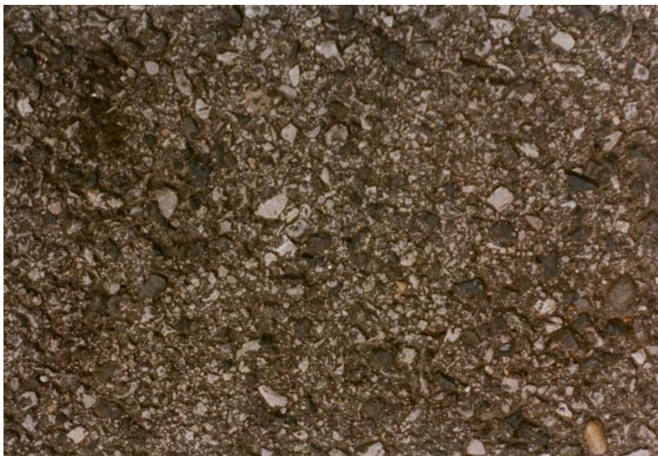
Rozpad krytu vozovky
