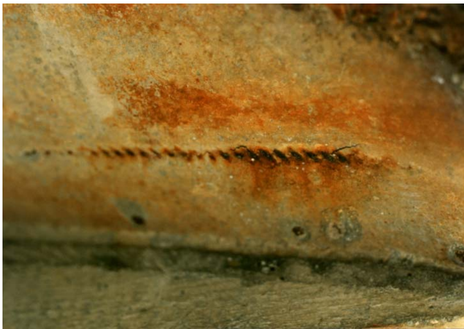
Nedostatočne krytá betonárska výstuž
