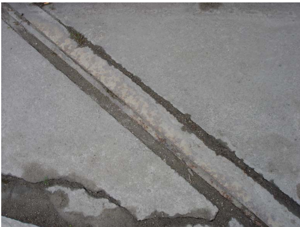
Nerovnoběžné hrany mostného záveru
