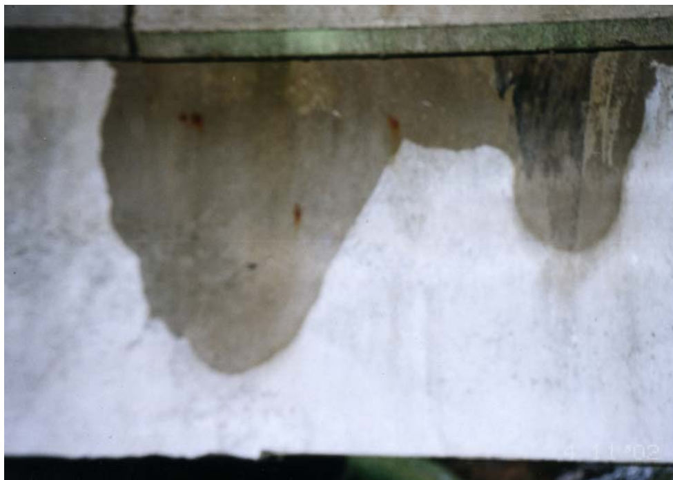
Vlhké škvrny na stene nosníka
