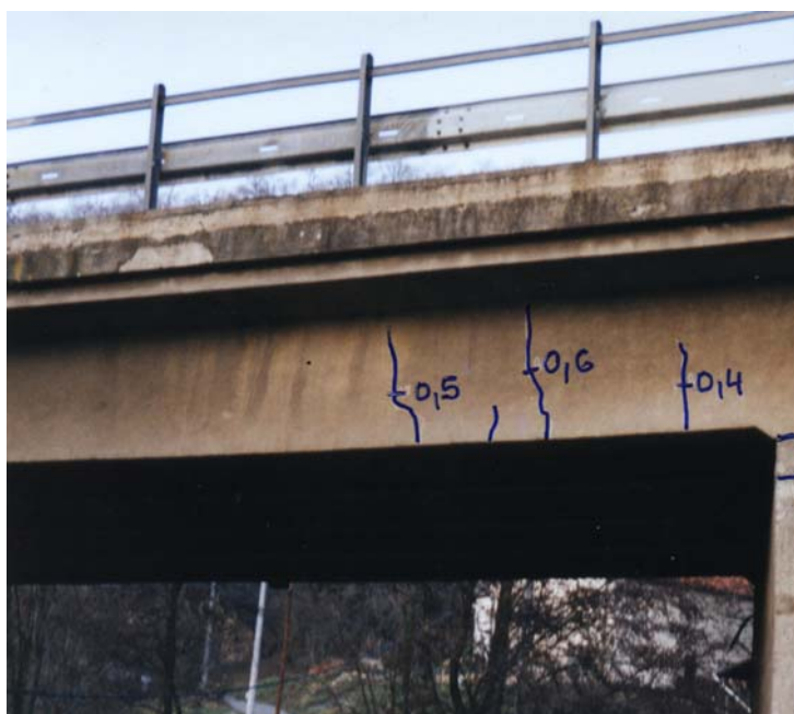
Priečne trhliny v krajnom tráme
