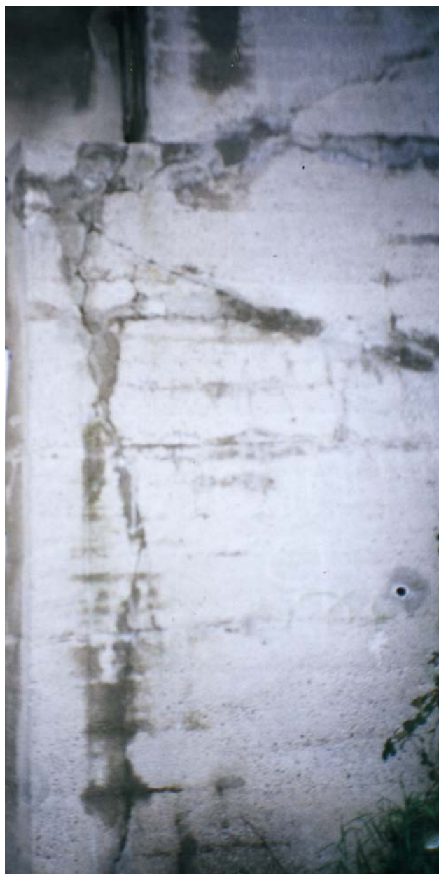
Vejárovité trhliny v křídle opory
