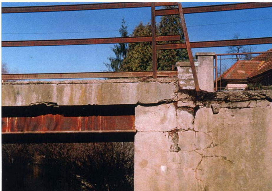
Záclony na korodujúcom nosníku
