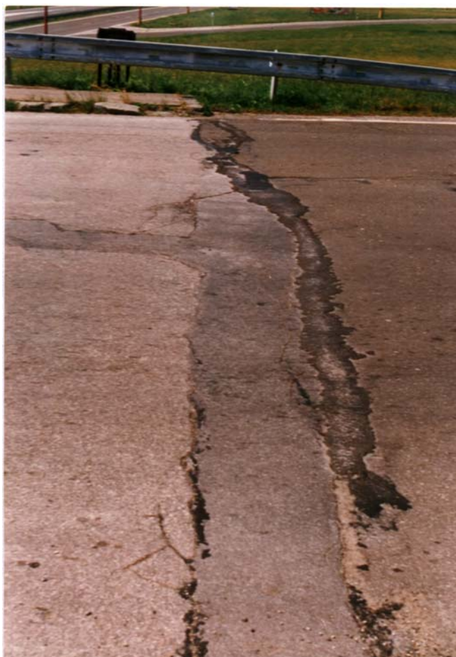
Trhlina nad podpovrchovým mostným záverom
