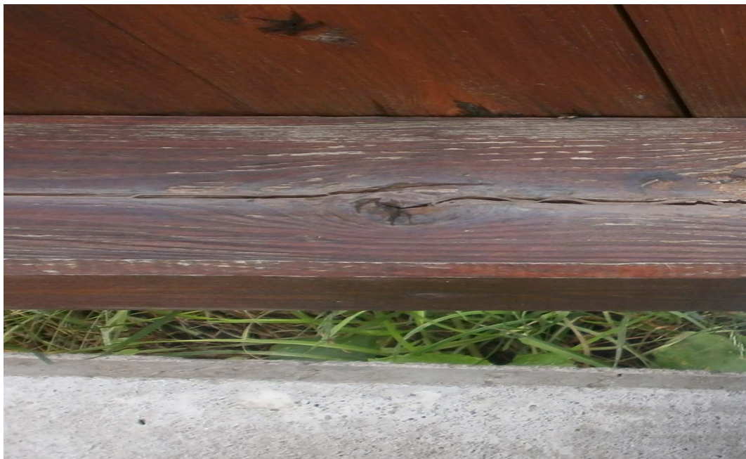
Pozdĺžne trhliny v dreve
