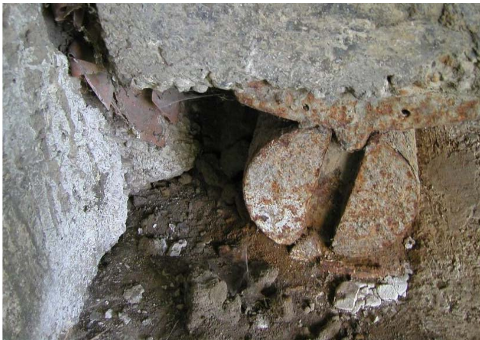
Porušenie smerového vedenia ocelového ložiska
