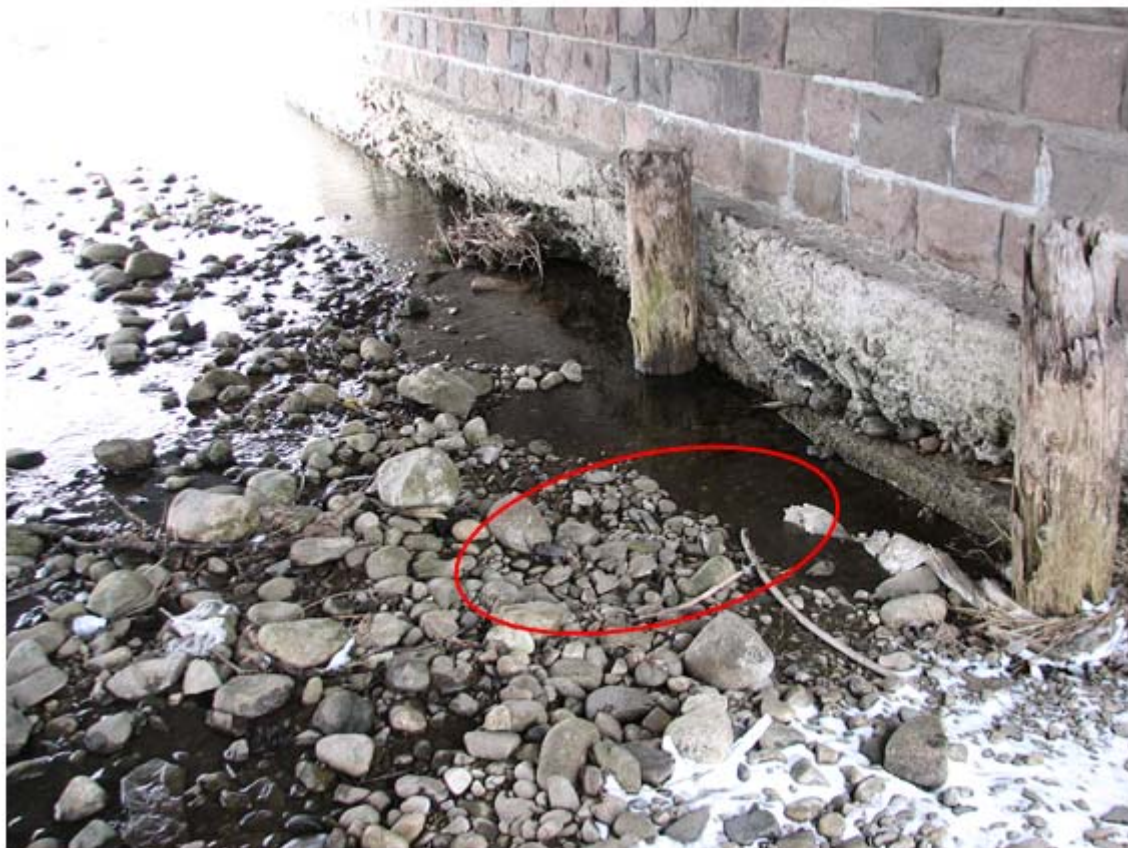
Poškodenie dna koryta toku
