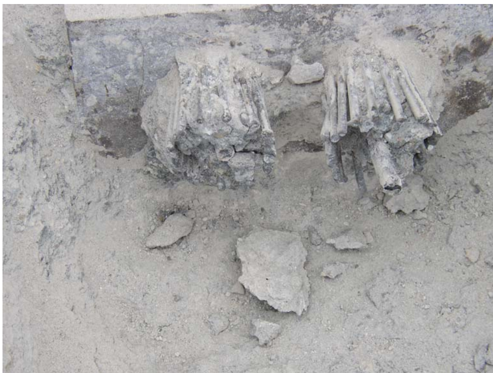
Nedostatočne chránená kotva
