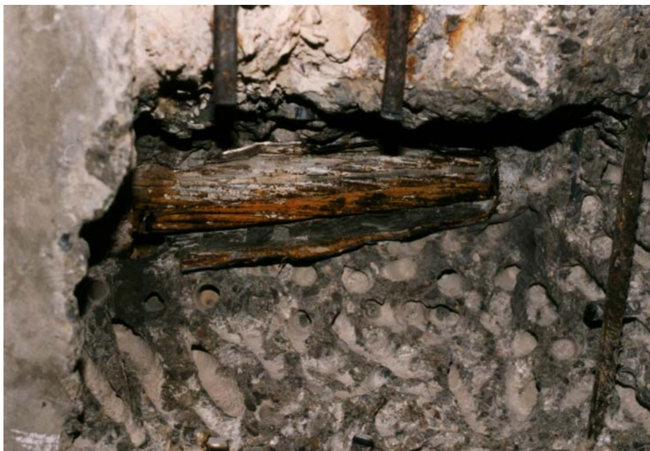
Otvorená sonda s obnaženým káblom a viditeľnou koróziou predpínacích lán
