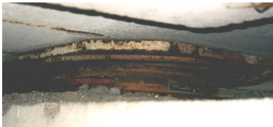
Ložisko s vyčerpanou kapacitou
