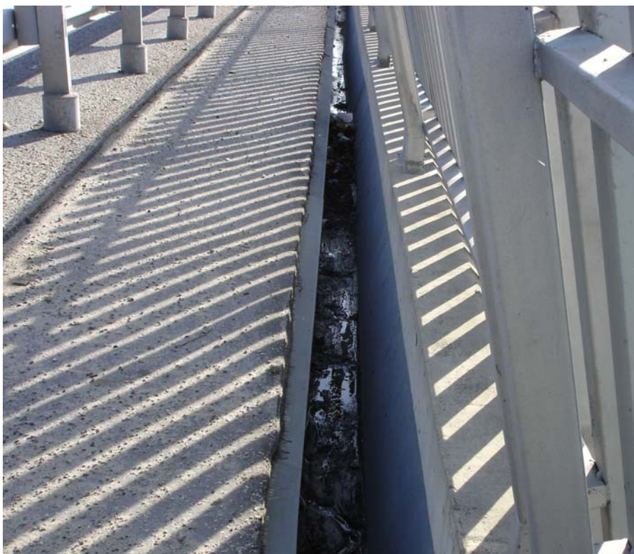
Odvodňovací žlab znefunkčnený nečistotami
