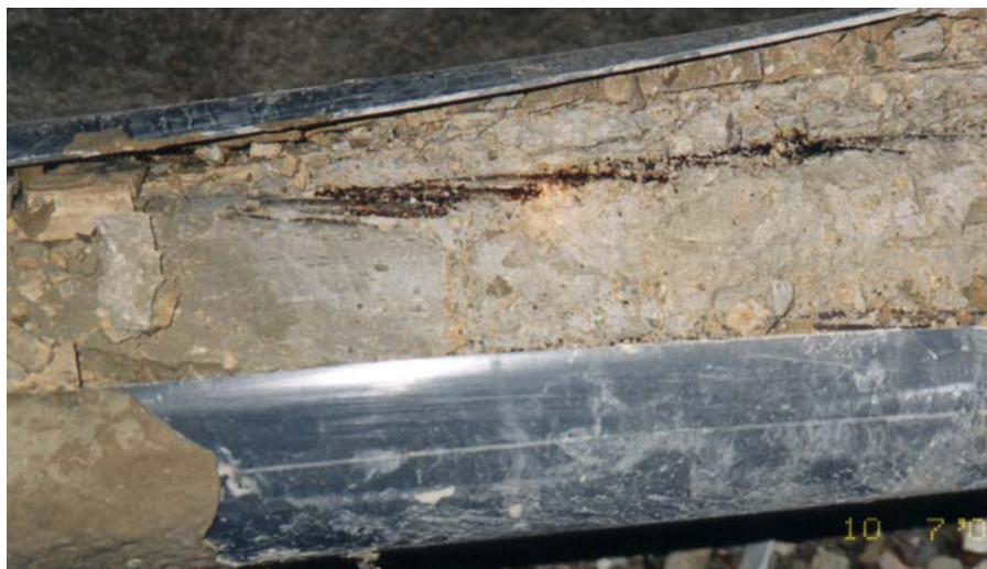
Poškodený ochranný obal voľného kábla a drobenie injektážnej malty
