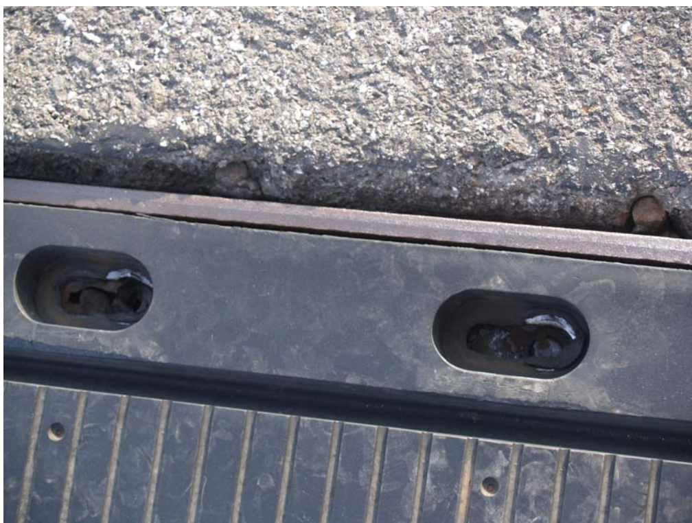
Odtrhnutie kotevných prútov od oceľového profilu záveru
