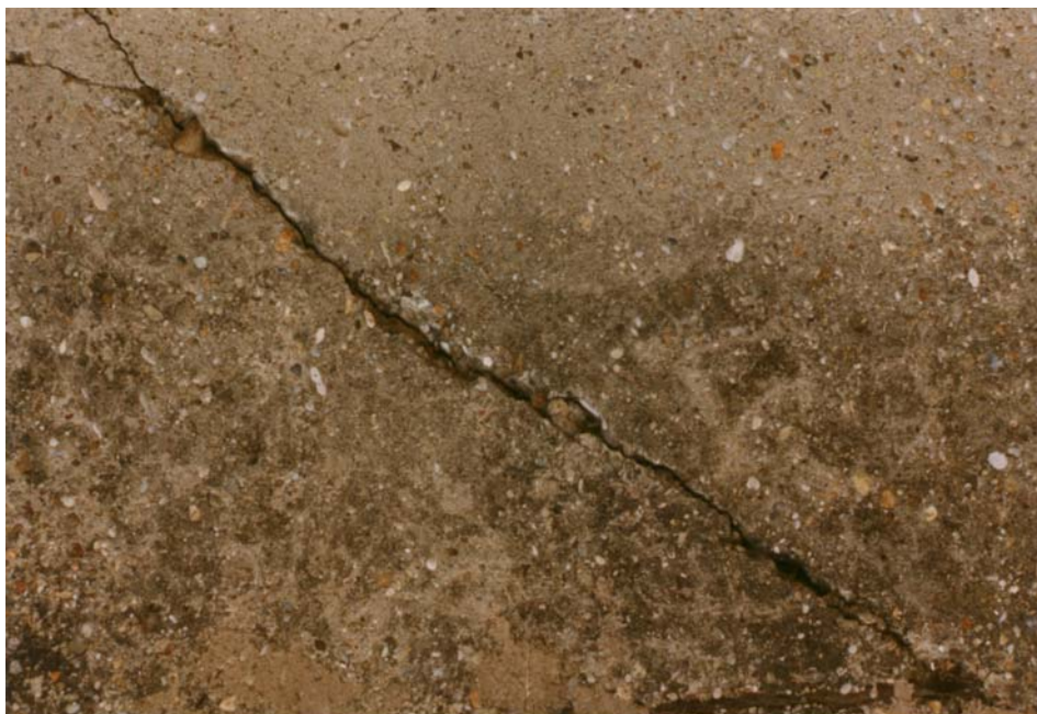
Prasklina v betónovom krídle
