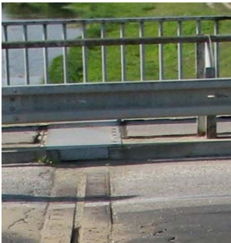
Nefunkčná dilatácia zvodidla/zábradlia
