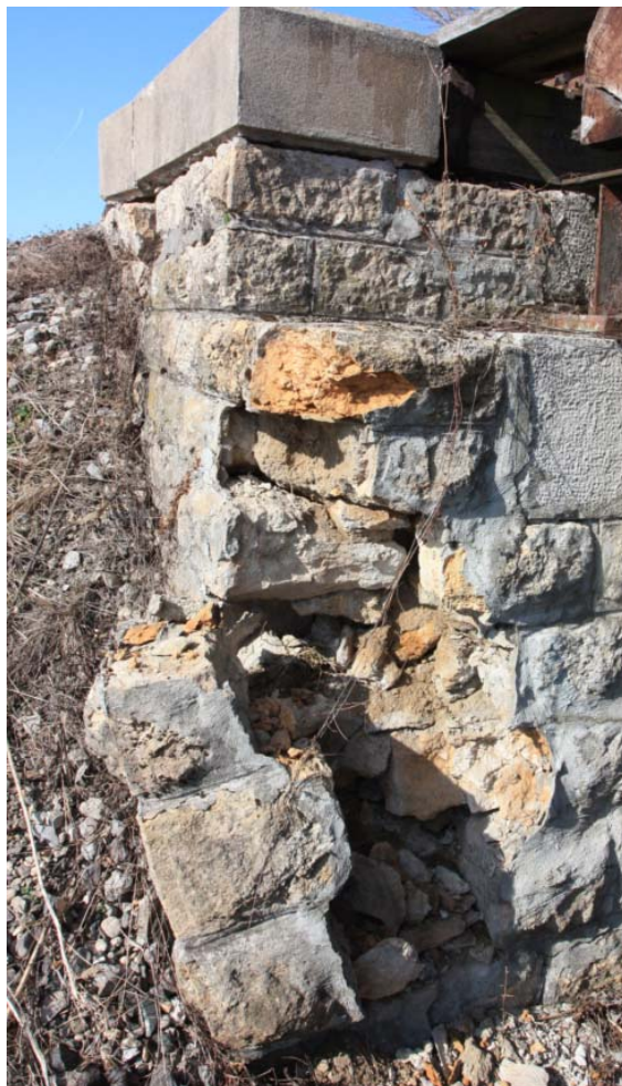
Zrútenie časti muriva na rohu opory mosta
