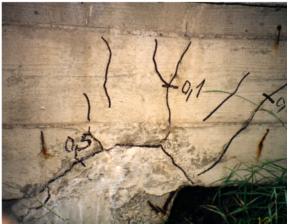
Šikmé trhliny v oblasti pripojenia tiaha k nosnej konštrukcii
