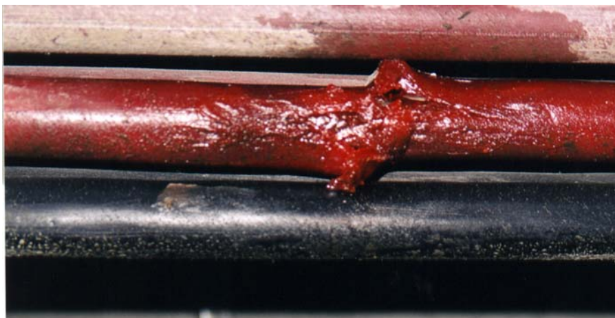
Poškodený PE obal monostrandu s vytekajúcim mazivom
