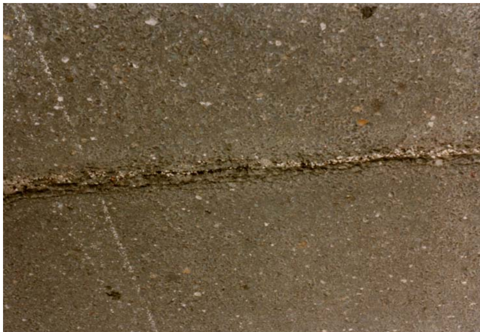
Priečna trhlina vo vozovke
