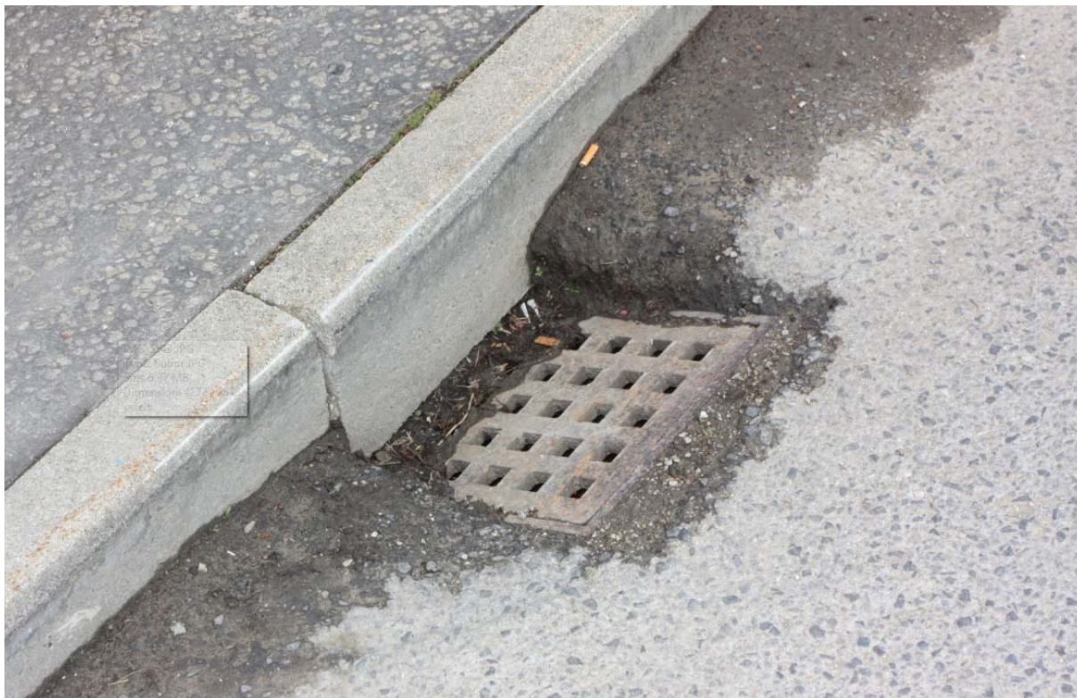
Zle osadený odvodňovač
