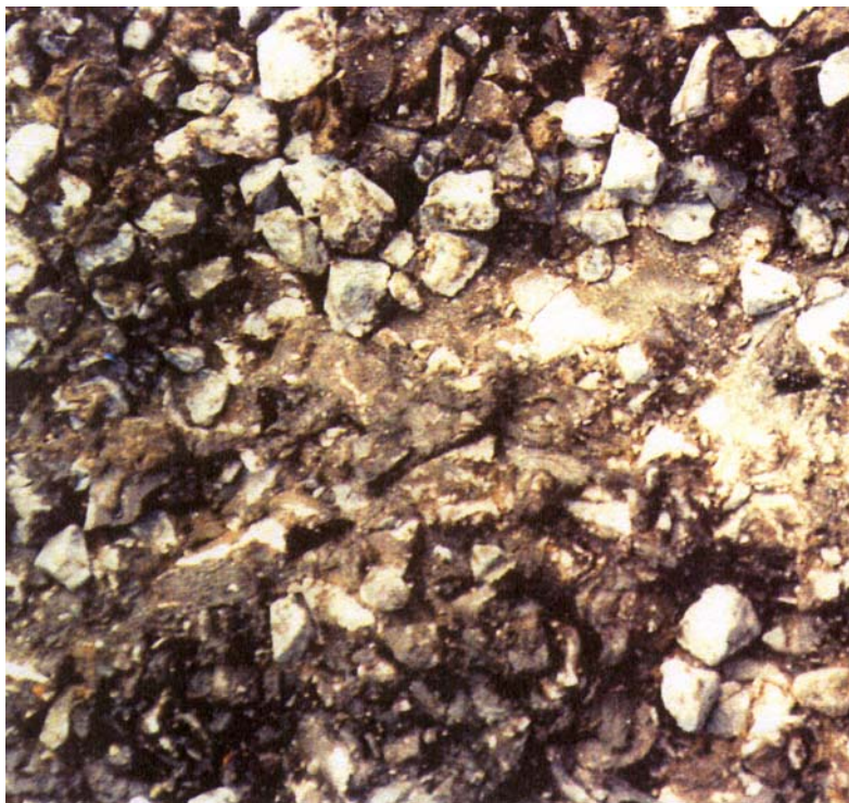
Vylomenie zŕn kameniva asfaltového záveru
