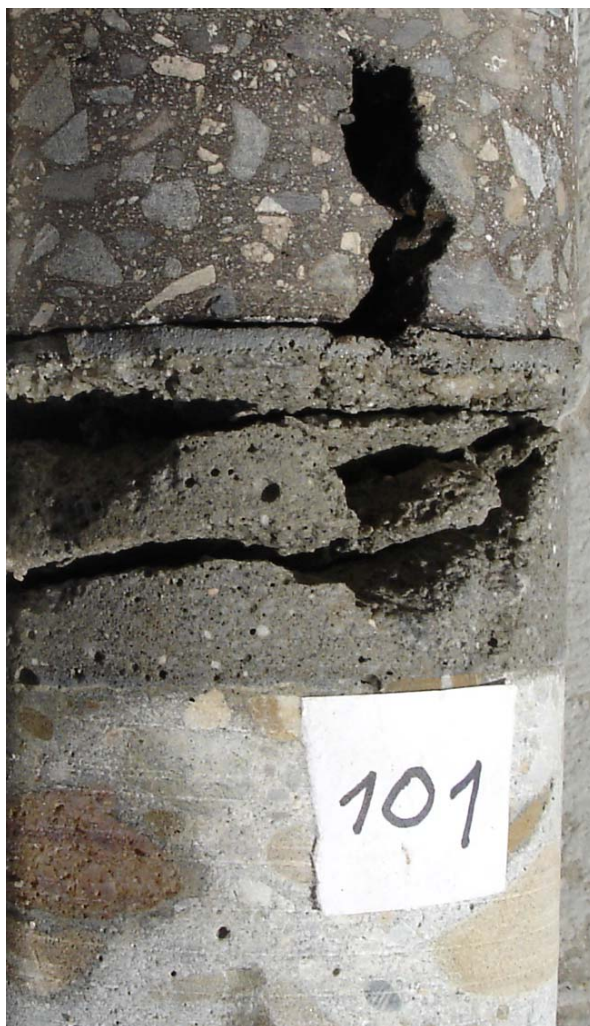
Popraskaná vyrovnávacia vrstva (vzorka jadrového vývrtu)
