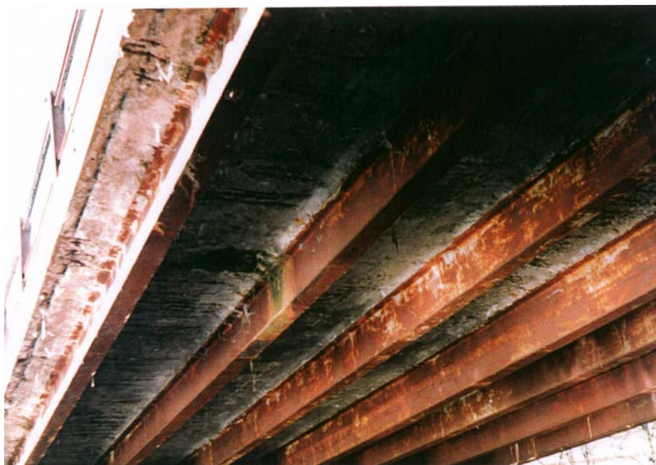
Korózia oceľových nosníkov spriahnutej konštrukcie
