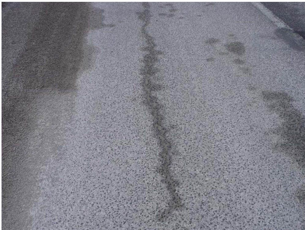
Pozdížna trhline vo vozovke
