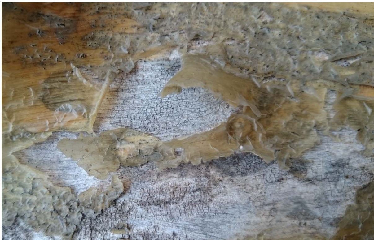
Poškodenie vrstvy náteru
