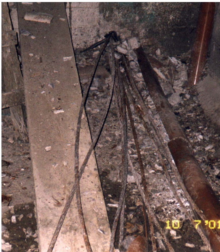
Úplné porušenie voľného kábla
