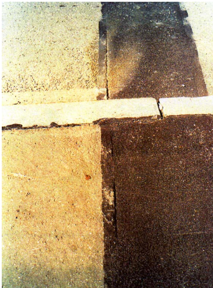
Odtrhnutie asfaltového záveru na okrajoch
