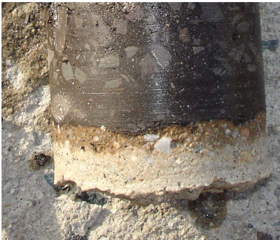
Nekvalitný materiál vyrovnávacej vrstvy (vzorka jadrového vývrtu)
