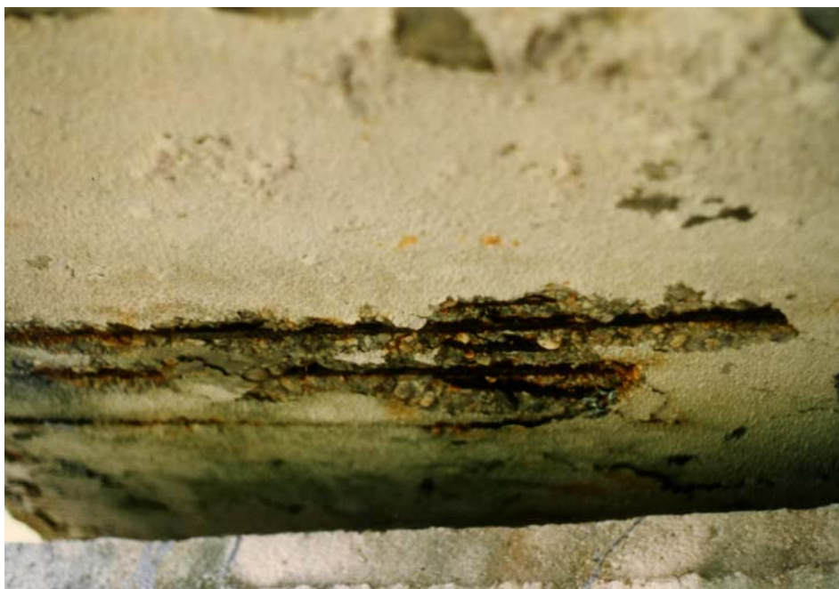
Korózia betonárskej výstuže
