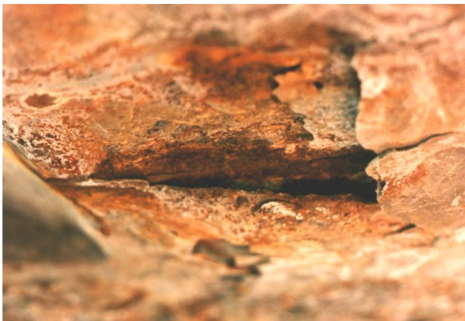
Betonárska výstuž oslabená koróziou
