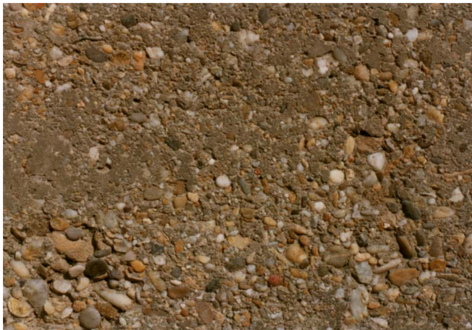
Obnažovanie zŕn na povrchu betónu
