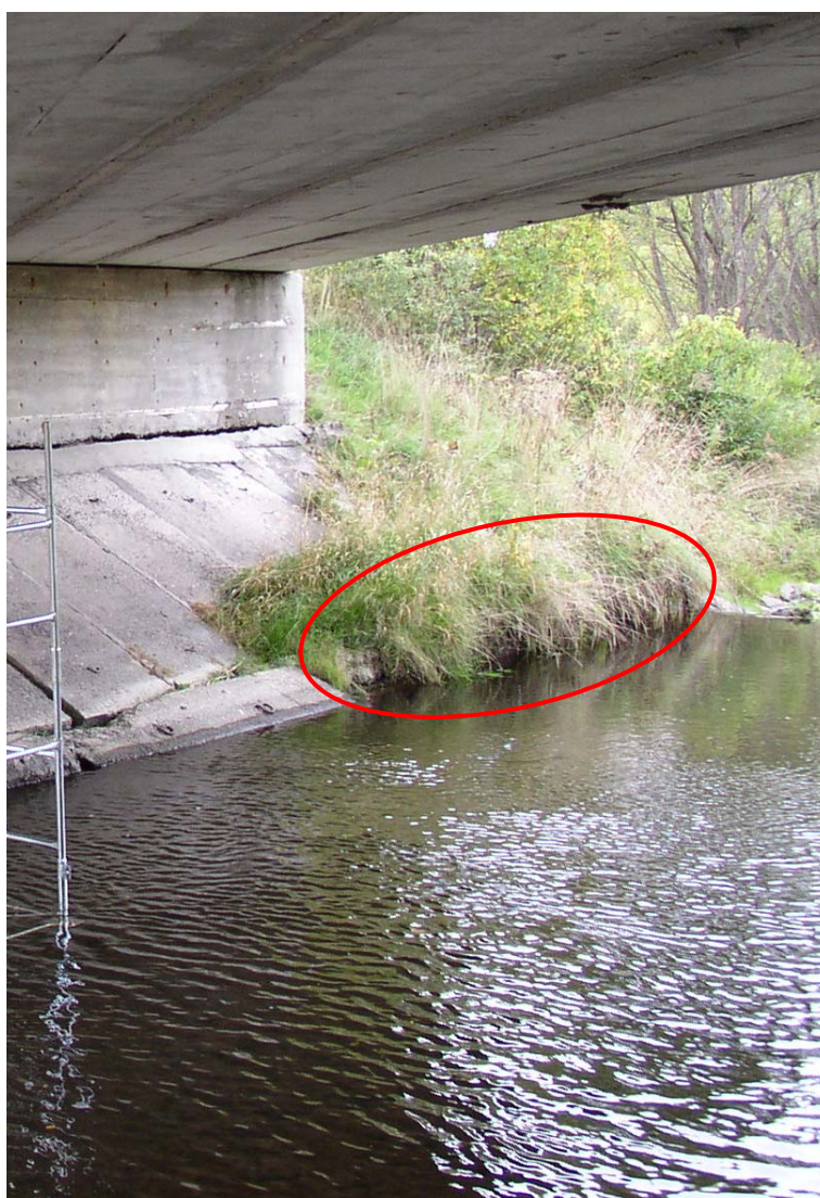
Poškodenie spevnia koryta toku
