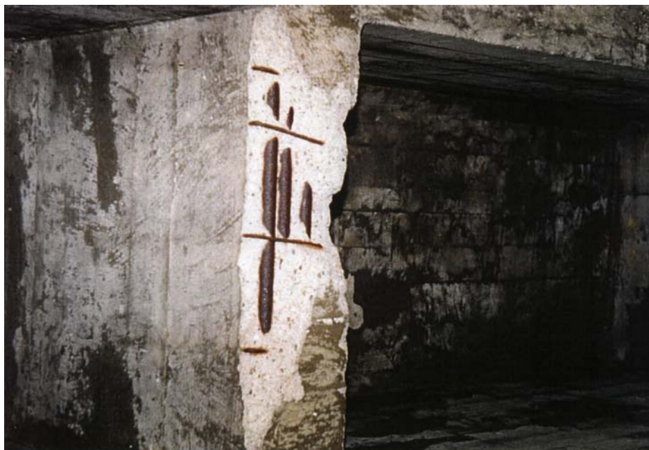
Obnažená nosná betonárska výstuž
