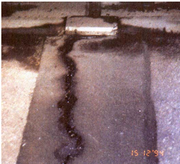
Trhliny v asfaltovom mostnom závere
