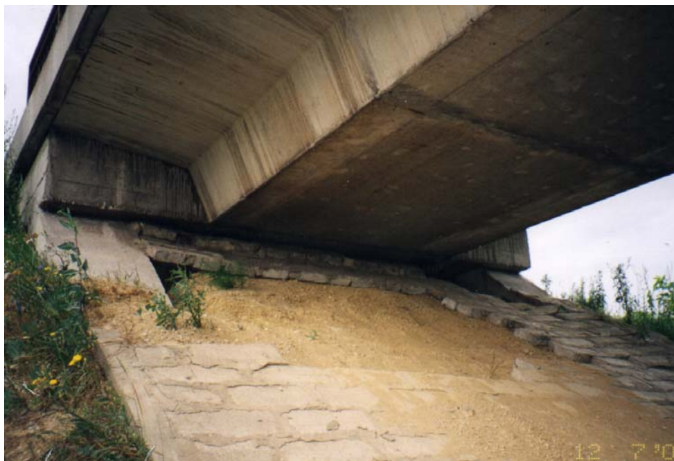
Poškodený obklad svahu
