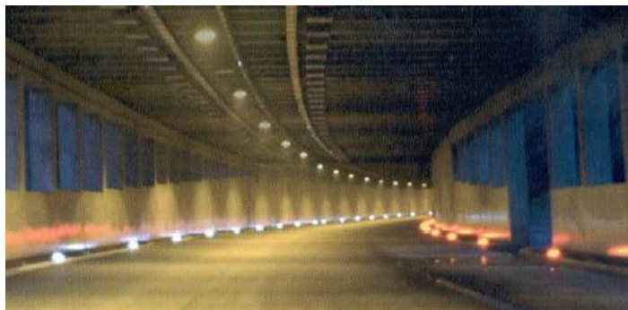
Obrázok 19 - Dopravné gombíky s aktívnou signalizáciou v tuneli
