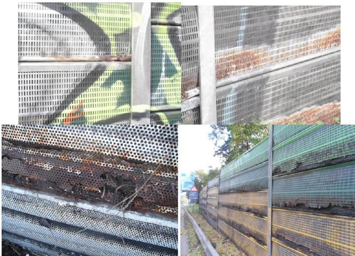
Obrázok 6 – Príklad degradácie konštrukcie spôsobenej koróziou
