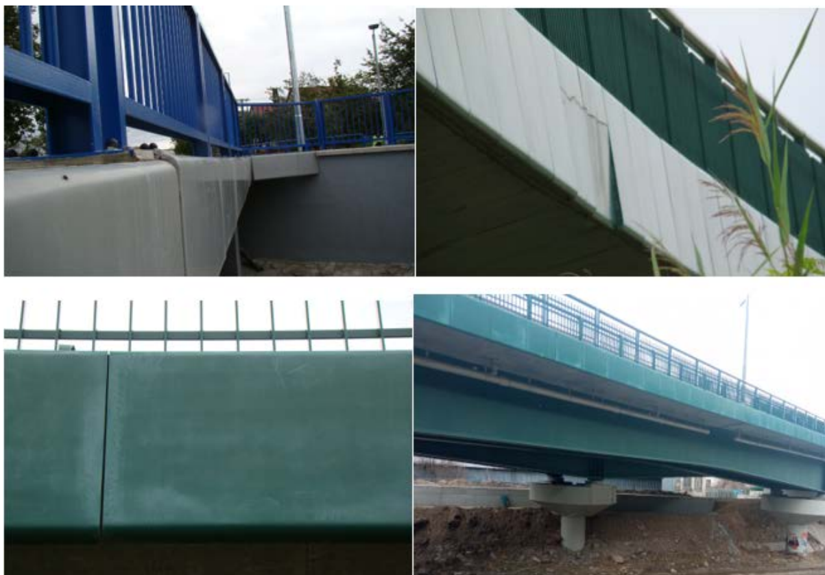
Obrázok 5 – Nežiadúce javy na stavbách s použitím polymerbetónových rímsových prefabrikátov
