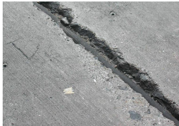
Obr. 55: Olámaná škára CB dosky na moste hraničného prechodu ČR so SRN Rozvadov / Waidhaus
