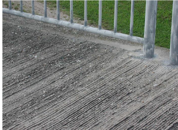
Obr. 63: Stav povrchu priamo pojazdnej mostovky lávky nad D5 v km 27,0
