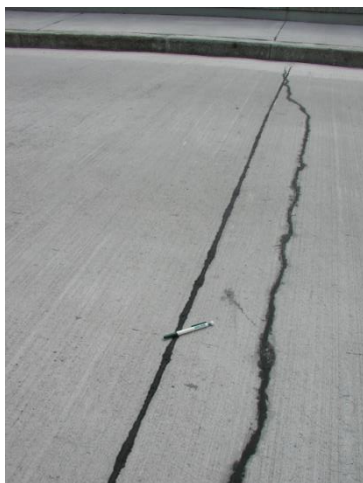
Obr. 59: Trhlina vedľa dilatačnej škáry
