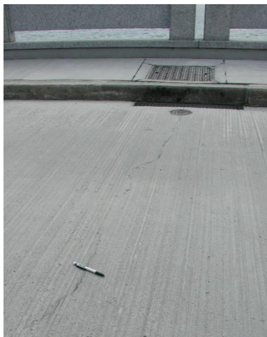
Obr. 58: Trhlina pri poklope vodovodného potrubia
