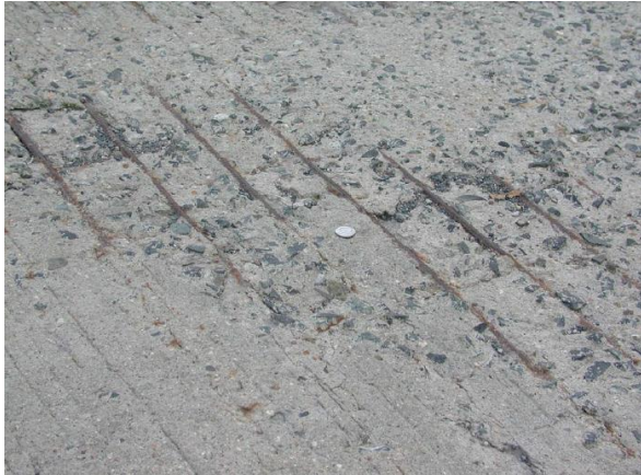
Obr. 62: Obnaženie výstuže priamo pojazdnej mostovky lávky nad D5 v km 21,5.
