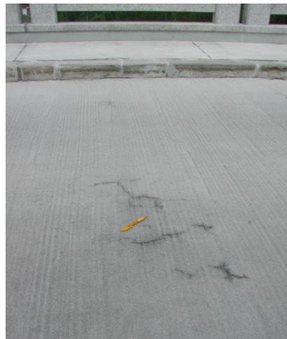
Obr. 60: Náhodné mapové trhliny na CB kryte násypového telesa
