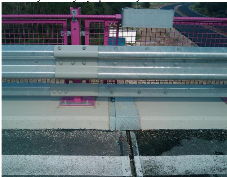
Obr. 44 Kvalitný izolačný styk preklenutý ťahadlom zábradlia a zákrytom mostného záveru
