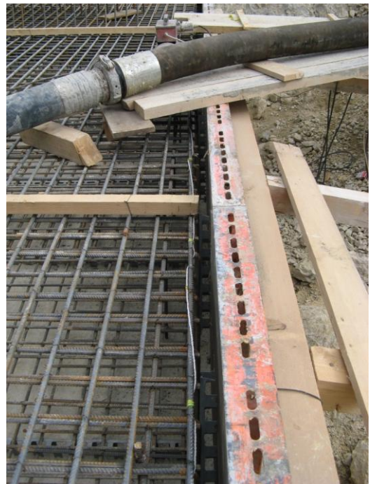
Obr. 17 Krytie výstuže 50 mm spodnej klenby – nevhodné plastové dištančníky (inštalácia diagnostiky korózie výstuže CMS na krajnom vystuženom prvku)
