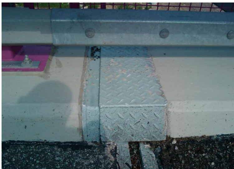
Obr. 45 Zákryt MZ je chybné zhotovený, dilatačnú škára preklenutá plechom, chýbajú podložky
