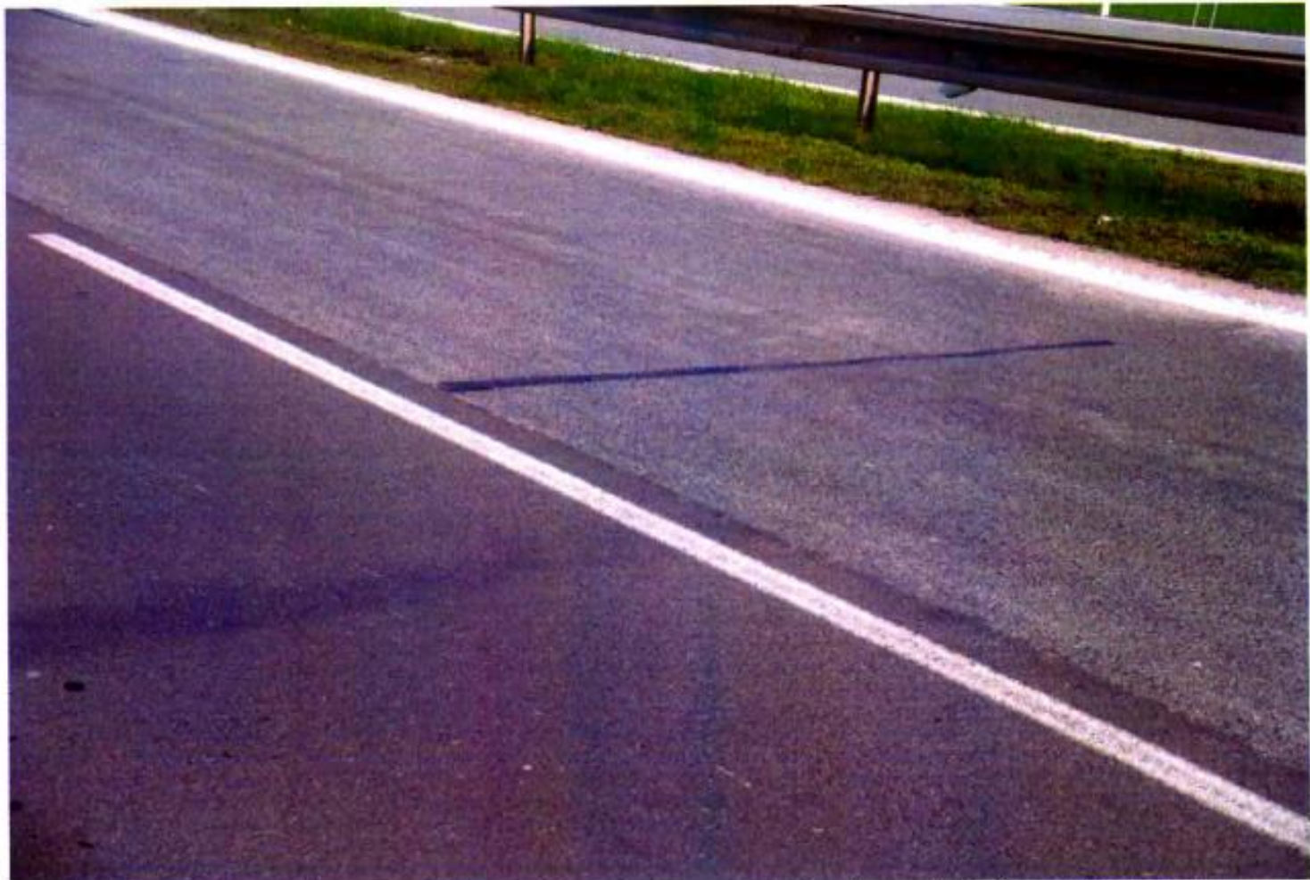
Obrázok č.1 Vľavo: opravovaná priečna trhlina, Vpravo: neprekopírovaná priečna trhlina
