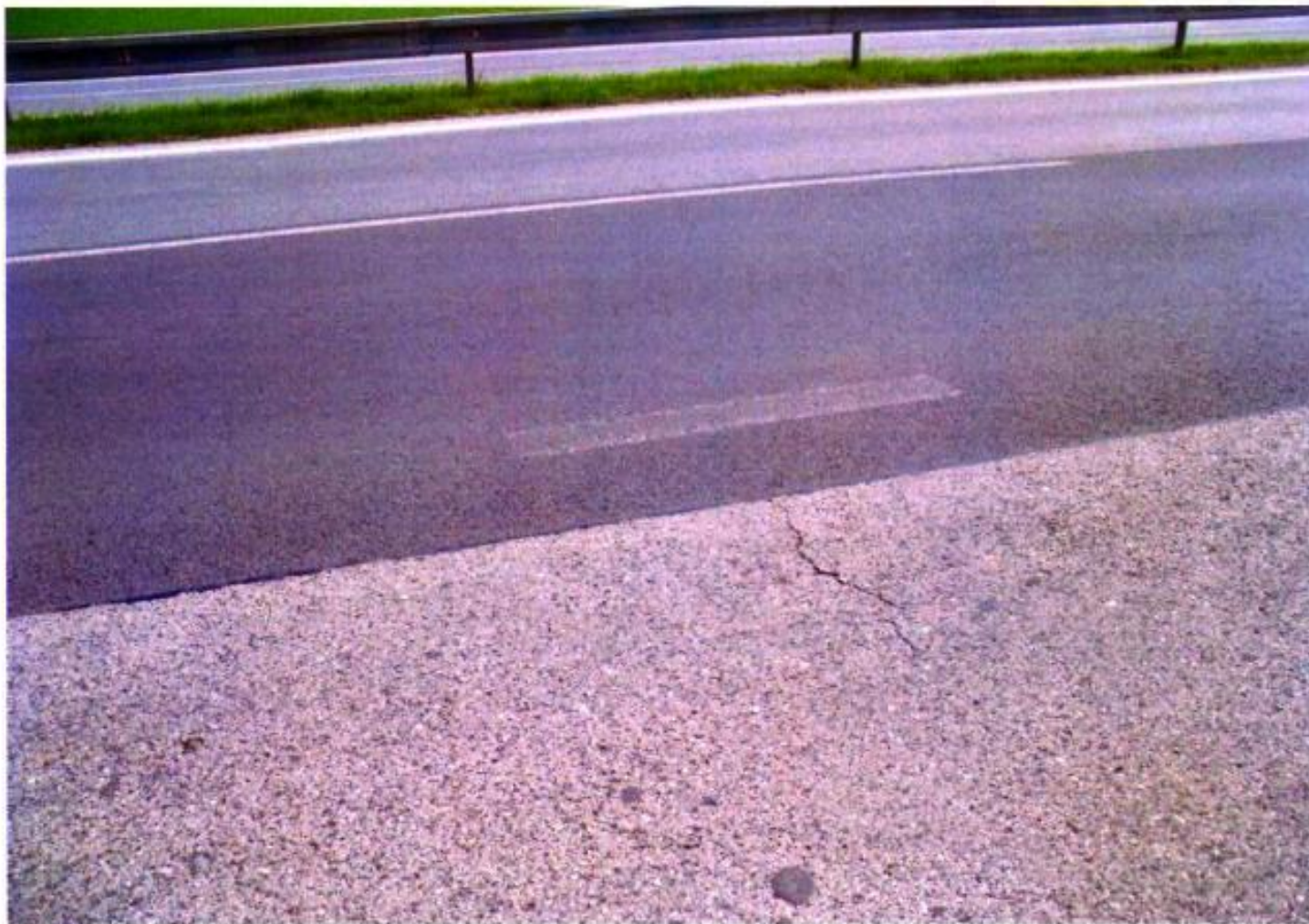
Obrázok 3 Neprekopírovaná priečna trhlina
