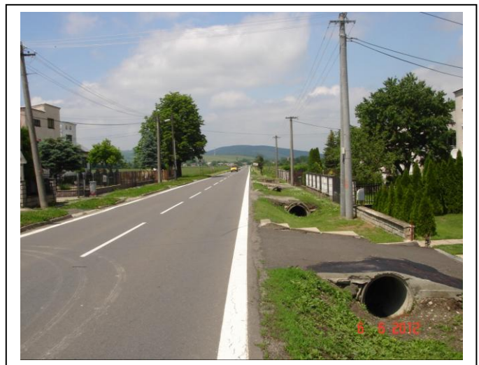
Kritické miesto v smere staničenia v km11,2
